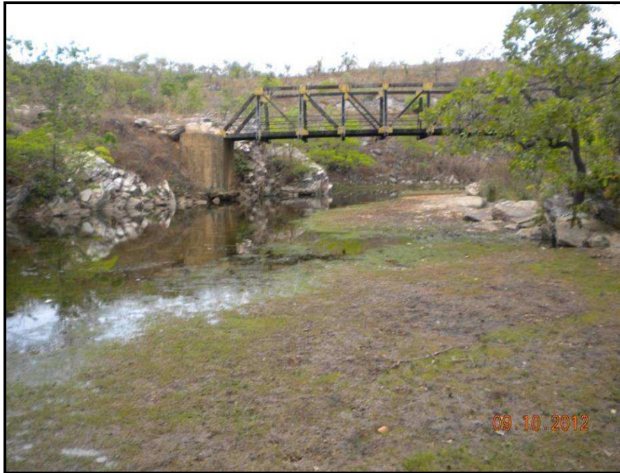
FOTO 19 – DETALHE DO ASSOREAMENTO NO LEITO DO RIO, PRÓXIMO A PONTE SOBRE O RIO DOS MACACOS (PONTO 19).
