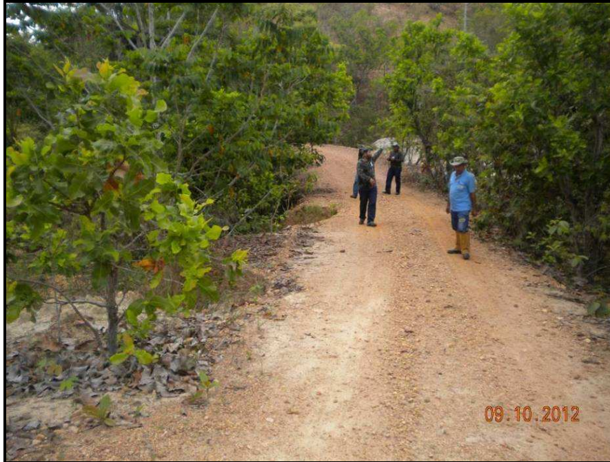
FOTO 31 – PONTO 26 - VISTA DA ESTRADA E EROSÃO NA LATERAL.
