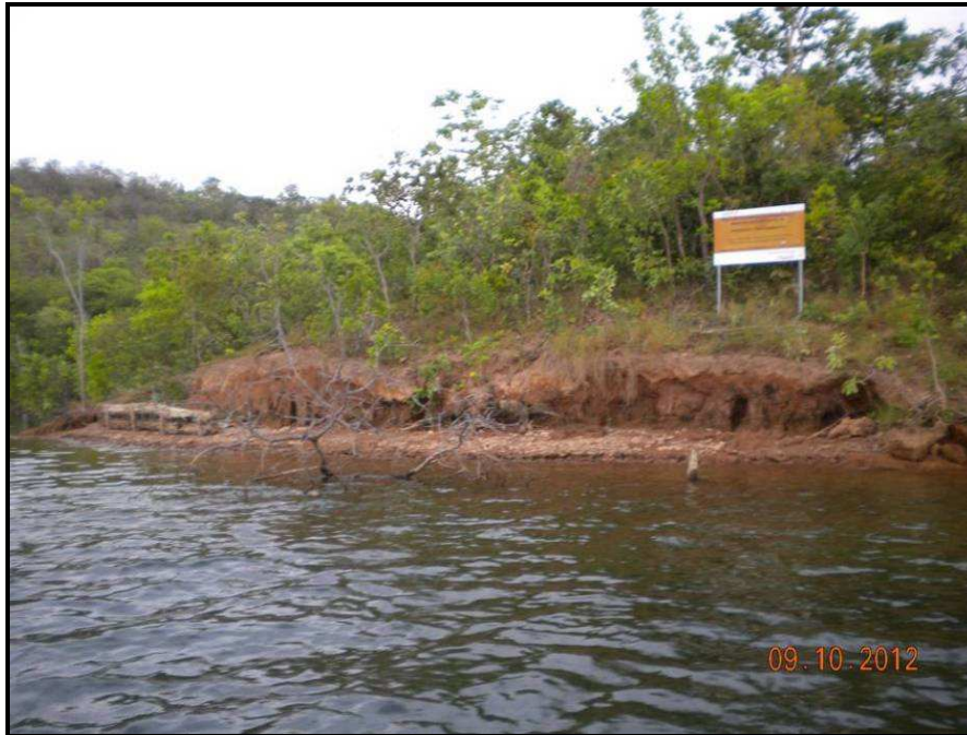
FOTO 29 – PONTO E - EROSÕES LOCALIZADAS EM TALUDES MARGINAIS. EFEITO EROSIVO POR AÇÃO DAS ONDAS, COM ASSOREAMENTO EM PROGRESSO.
