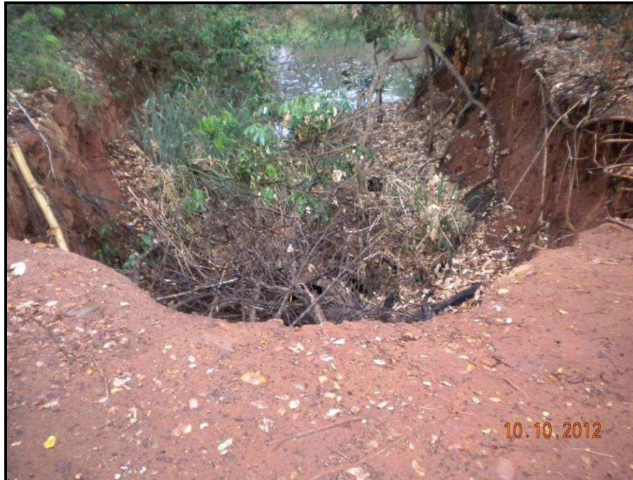
FOTO 5 – MARGEM ESQUERDA DO RIO BONITO – VISTA GERAL DA EROSÃO NO DESÁGUE DA REDE PLUVIAL DA VILA DE FURNAS.
