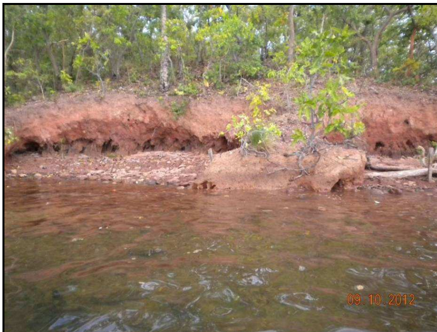
FOTO 30 – PONTO E - EROSÕES/SOLAPAMENTO – CAUSANDO ASSOREAMENTO LOCAL.
