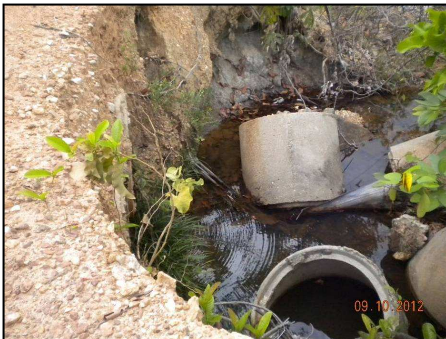
FOTO 32 – PONTO 26 – DRENAGEM COMPROMETIDA NA LATERAL DA ESTRADA.
