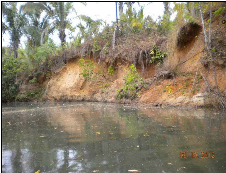
FOTO 15 – VISTA DO PROCESSO EROSIVO NA MARGEM (PONTO 30).
