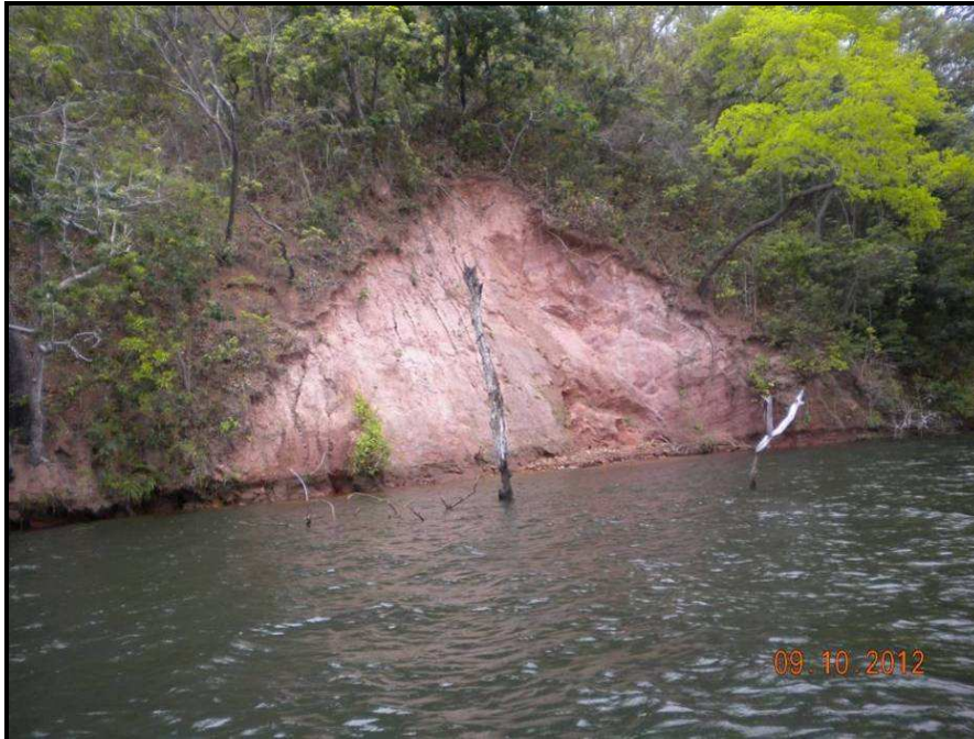
FOTO 20 – PONTO 16 – TALUDE NA MARGEM DIREITA DO RIO TOCANTINS. ESCORREGAMENTO E EROSÕES POR ONDAS.
