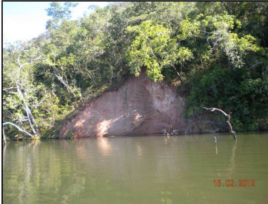
FOTO 20 – PONTO 16 - BARRANCA NA MARGEM DIREITA DO RIO TOCANTINS. EROSÕES POR EMBATE DE ONDAS, MATERIAL SAPROLÍTICO, MUITO FRÁVEL, COM BAIXA COESÃO EM TALUDE SV. EVOLUÇÃO DO ASSOREAMENTO.
