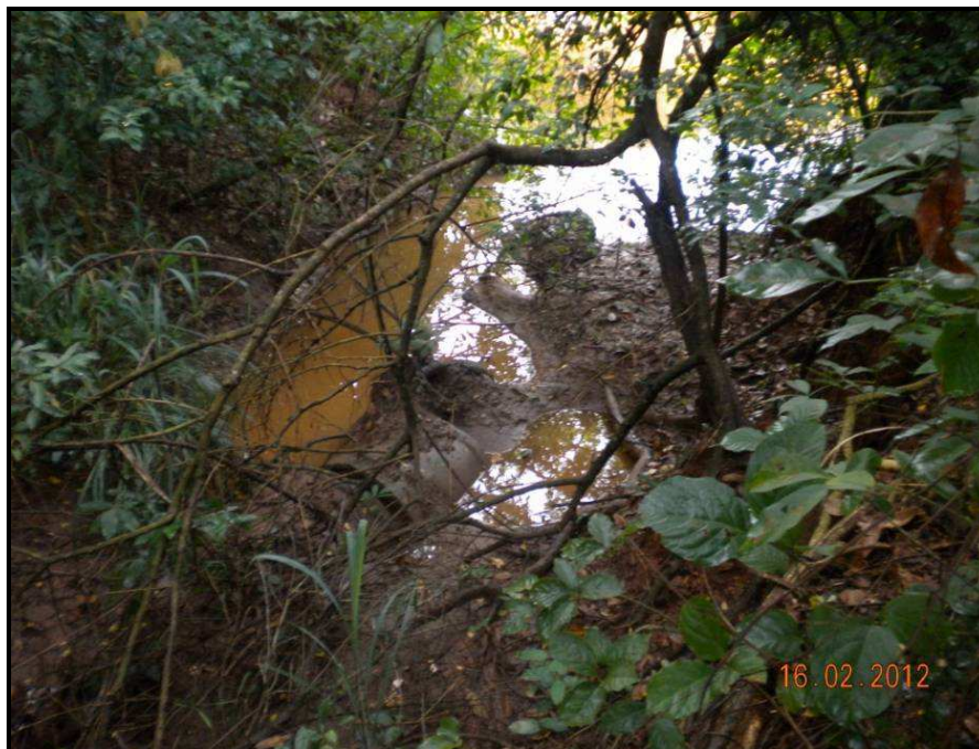
FOTO 3 – MARGEM ESQUERDA DO RIO BONITO - DESÁGÜE DA REDE PLUVIAL DA VILA DE FURNAS.
