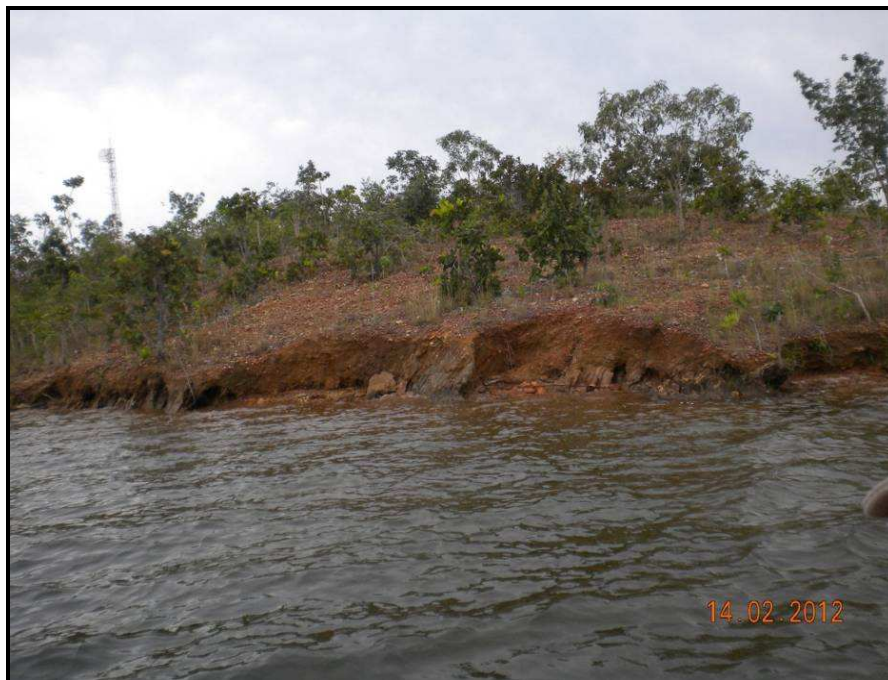
FOTO 30 – PONTO E - EROSÕES/SOLAPAMENTO/ASSOREAMENTO.
