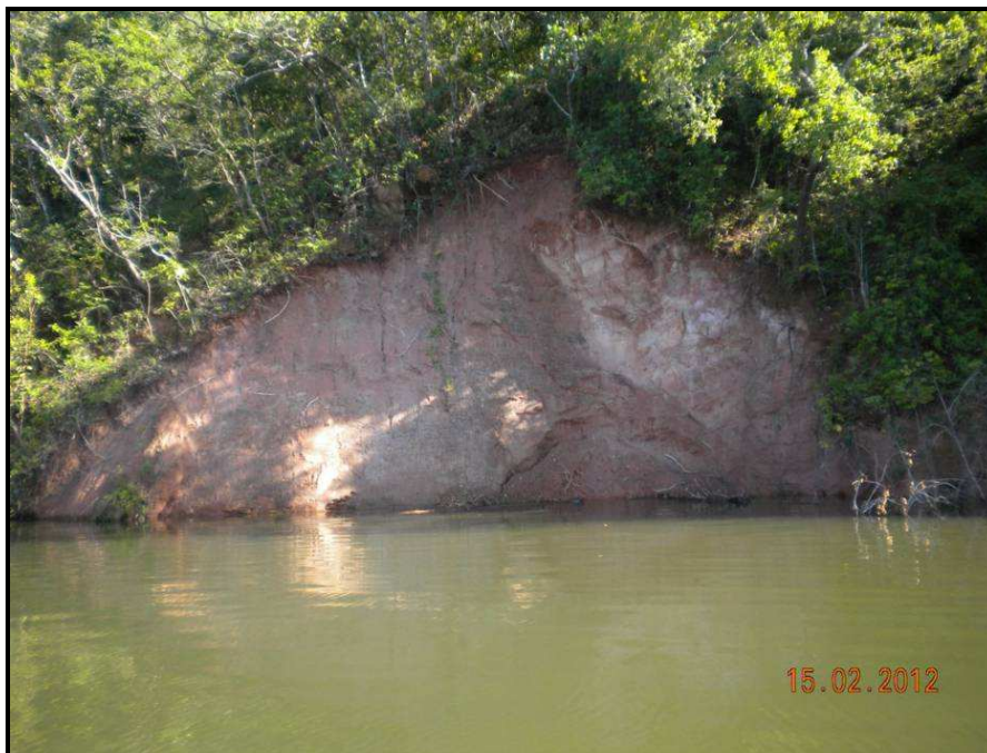
FOTO 21 – PONTO 16 - NOTAR A ESTRUTURA RELIQUIAR DA ROCHA NO MATERIAL SAPROLÍTICO, MUITO ERODÍVEL. ASSOREAMENTO EM PROGRESSO.
