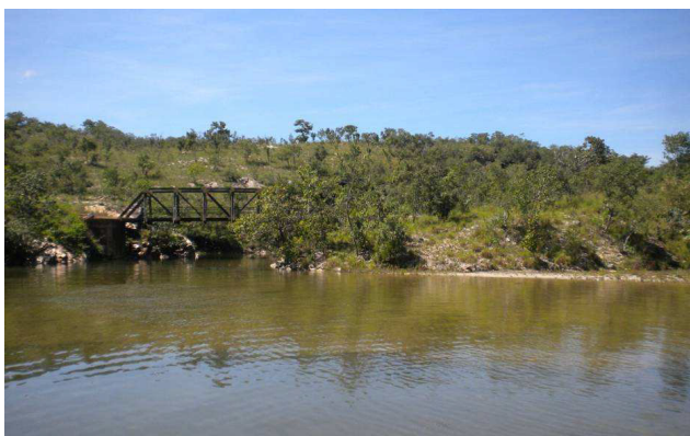
c) Ponto 19 – Assoreamento no rio dos Macacos.
