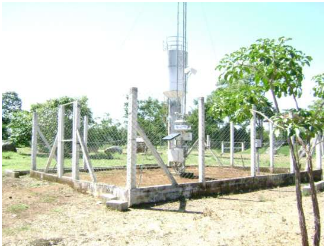
Foto da estação meteorológica automática instalada no sítio da UHE – Cana Brava
