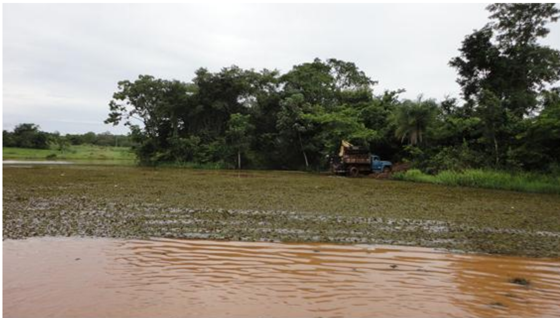
Figura 05: Vista da operação de carregamento mecânico das macrófitas na região do Rio Bonito.
