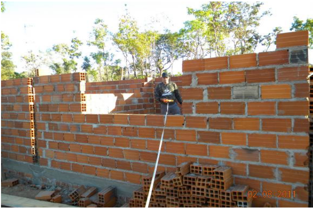
c) Casa com parte da construção na APP (RE-04)
