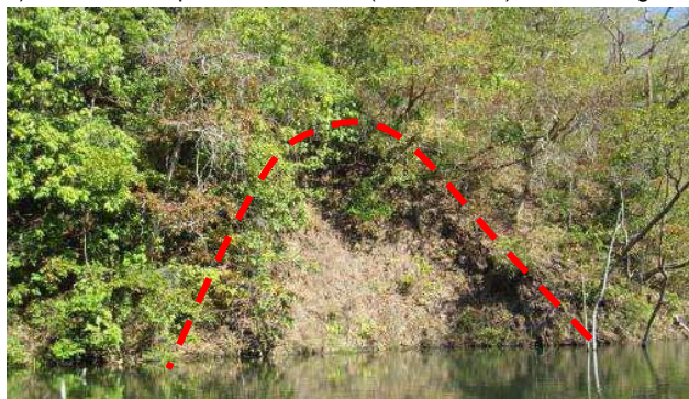
e) Ponto 25 – Escorregamento estabilizado.
