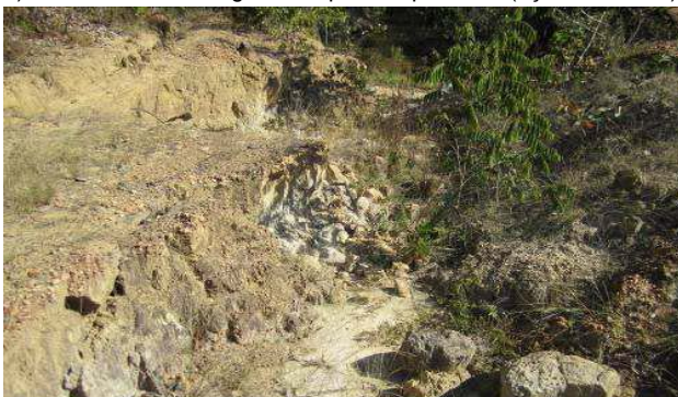
f) Ponto 26 – Vista da erosão no corpo do aterro da estrada.
