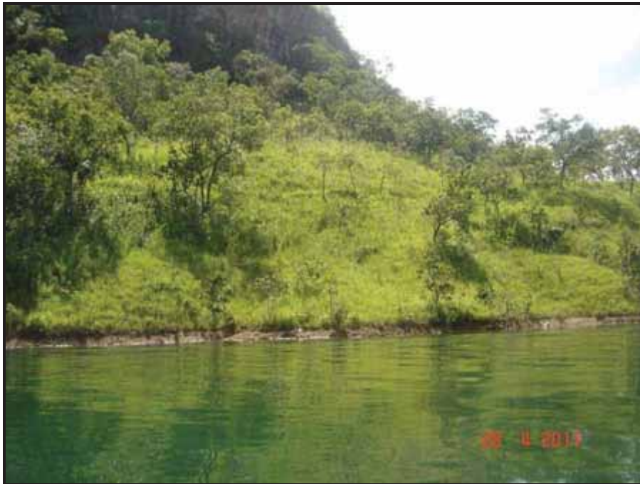
FOTO 29 – PONTO 15 - VISTA PARA MONTANTE DO MATERIAL COLÚVIAL/TÁLUS EM ENCOSTA CÔNCAVA DO TALUDE MARGINAL.
