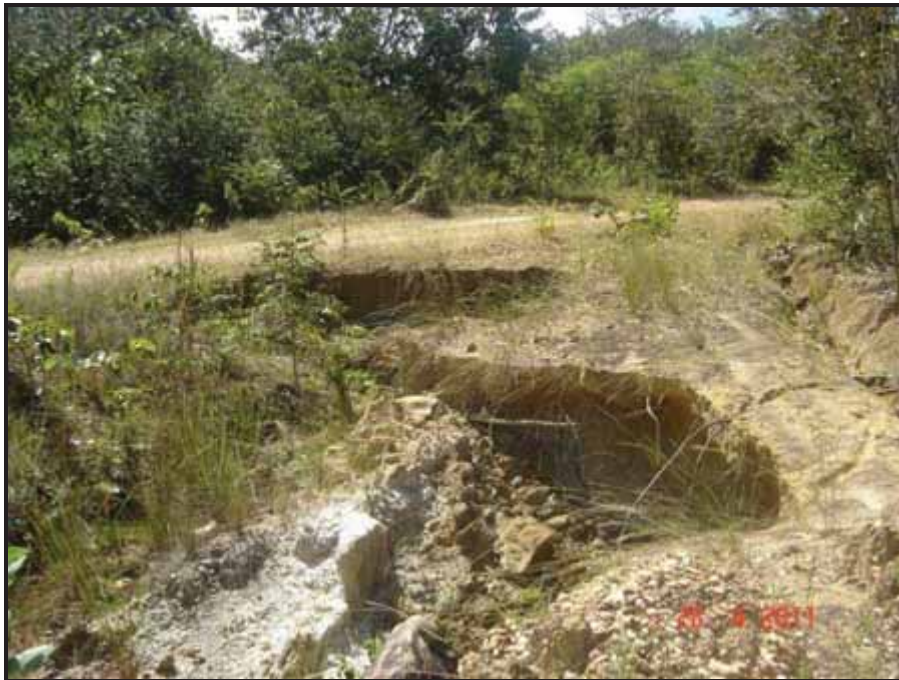
FOTO 19 – VISTA DA EROÇÃO NO LE DO CORPO DE ATERRO DA ESTRADA (PONTO 26).
