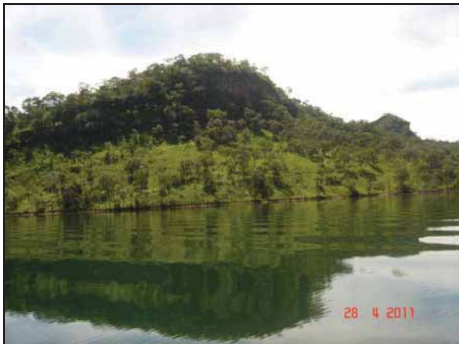
FOTO 28 – VISTA PARA MONTANTE DO MATERIAL COLUVIAL/TÁLUS, CONFORMANDO A ENCOSTA CÔNCAVA DO TALUDE MARGINAL. PONTO 15.
