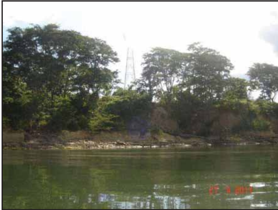
FOTO 41 – PUNTO G – VISTA EROSION TORRE III A JUSANTE DA BARRAGEM CANA BRAVA.
