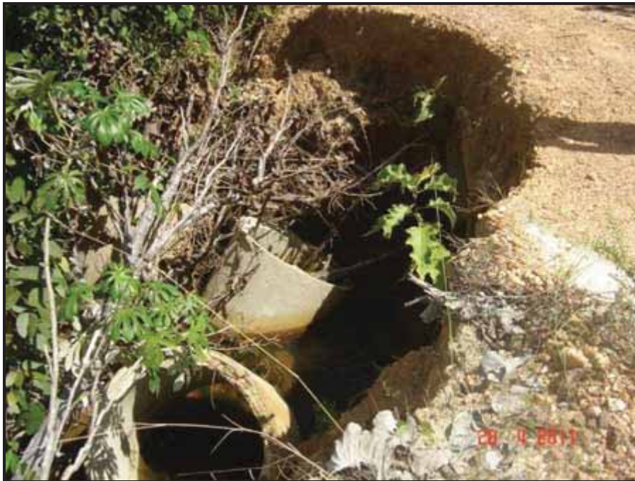
FOTO 17 – DETALHES DAS ESTRUTURAS DE DRENAGEM, INADEQUADAS E DETERIORADAS, A JUSANTE DO CORPO DE ATERRO DA ESTRADA (PONTO 26).
