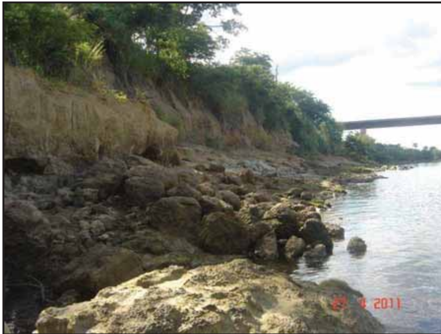
FOTO 45 - DETALHE DO INTENSO PROCESSO EROSIVO NA MARGEM ESQUERDA PRÓXIMO AO PONTO G TORRE III LOCAL ONDE DEVERÃO SER DESENVOLVIDAS AÇÕES DE CONTENÇÃO DO PROCESSO EROSIVO.
