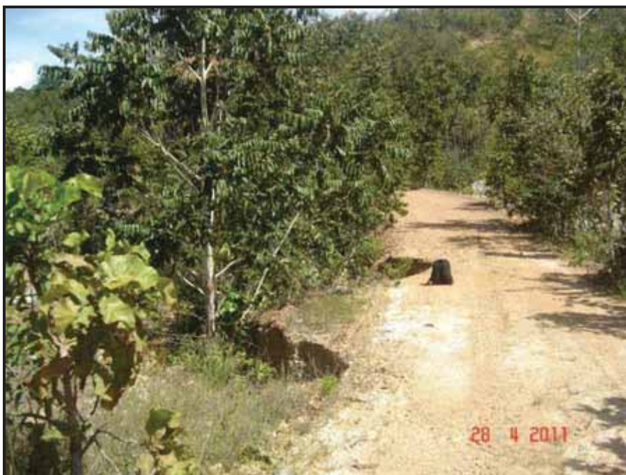
FOTO 18 – DETALHE DO ROMPIMENTO ONDE NA VISTORIA ANTERIOR VERIFICAVA-SE UMA TRINCA DE TRAÇÃO NO CORPO DE ATERRO DA ESTRADA (PONTO 26).
