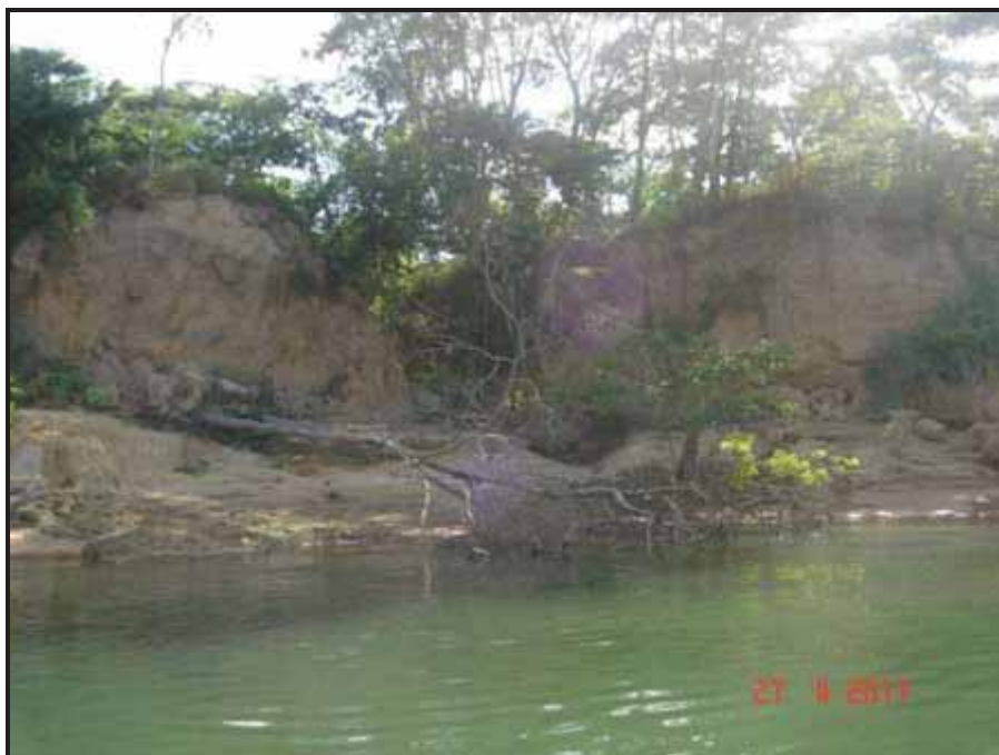
FOTO 44 – VISTA DE EROSIÃO DE GRANDE PORTE PRÓXIMO A TORRE III COM O TOMBAMENTO DE ÁRVORES DE GRANDE PORTE NA MARGEM ESQUERDA DO RIO TOCANTINS, IMPACTANDO AMBIENTALMENTE, ACELERANDO OS PROCESSOS DE EROSIÕES SUPERFICIAIS E O CONSEQÜENTE RISCO A BASE MUITO PRÓXIMA DA TORRE III.
