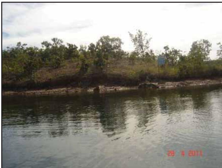
FOTO 39 – PONTO E - EROSÕES LOCALIZADAS EM TALUDES MARGINAIS. EFEITO EROSIVO POR AÇÃO DAS ONDAS, COM ASSOREAMENTO EM PROGRESSO.
