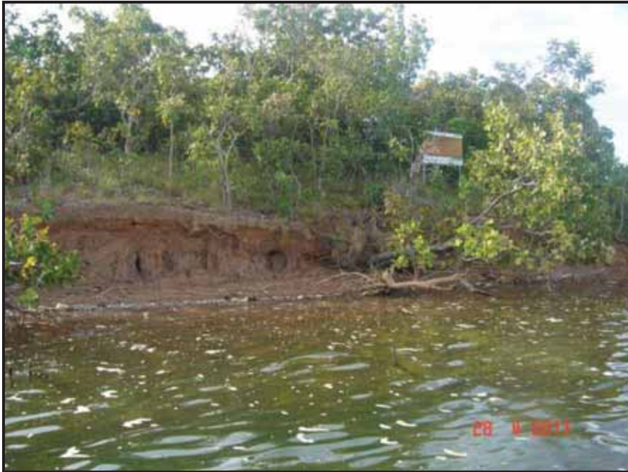
FOTO 38 – ILHA 75. EROSIÃO POR EMBATE DE ONDAS EM TALUDES MARGINAIS DE DIVERSAS ILHAS NO RESERVATÓRIO. NOTAR A ERODIBILIDADE DO SOLO SUPERFICIAL DE ROCHA XISTOSA/GNAISSE (?). ASSOREAMENTO EM PROGRESSO COM QUEDA DE VEGETAÇÃO.
