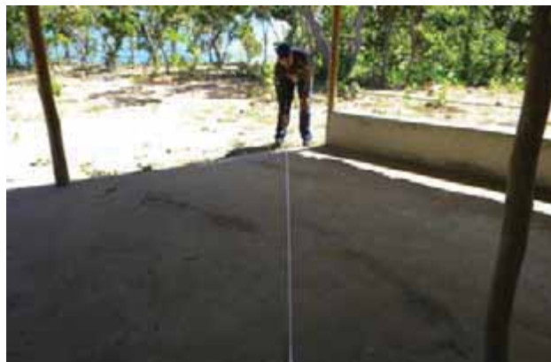
d) Construção irregular na APP
