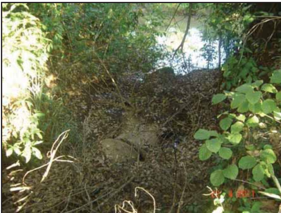
FOTO 7 – MARGEM ESQUERDA DO RIO BONITO - DESÁGÜE DA REDE PLUVIAL DA VILA DE FURNAS.
