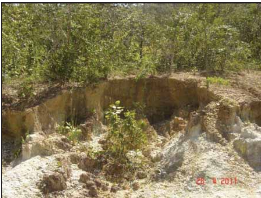
FOTO 16 – MARGEM ESQUERDA DO RIO TOCANTINS, PRÓXIMO À FOZ DO RIO DAS PEDRAS (PONTO 26). NOTÁVEL EVOLUÇÃO DE EROSÕES, ASSOREAMENTO EM PROGRESSO.
