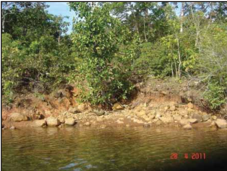
FOTO 43 – DETALHE DO PONTO F, COM INFLUÊNCIA DE ÁREA DEGRADADA (ANTIGA ESTRADA) EM SOLO RESIDUAL COLUVIONAR, MUITO ERODÍVEL. EM EVOLUÇÃO DE SEUS PROCESSOS EROSIVOS/ASSOREAMENTO A MONTANTE DA BARRAGEM, NA MARGEM ESQUERDA.
