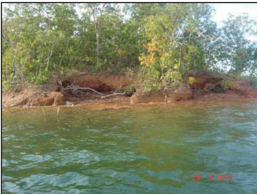
FOTO 35 – EROSÕES / ASSOAREAMENTO, POR AÇÃO DE ONDAS EM TALUDES BAIXOS DE DIVERSAS ILHAS NO RESERVATÓRIO DA UHE CANA BRAVA. PONTO C (ILHA 75).
