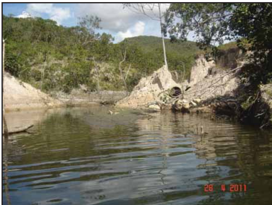
FOTO 12A – PONTO 21 – RUPTURA DE ATERRO DEVIDO BAIXA CAPACIDADE DE VAZÃO DE BUEIROS E EROSÕES NOS TALUDES.
