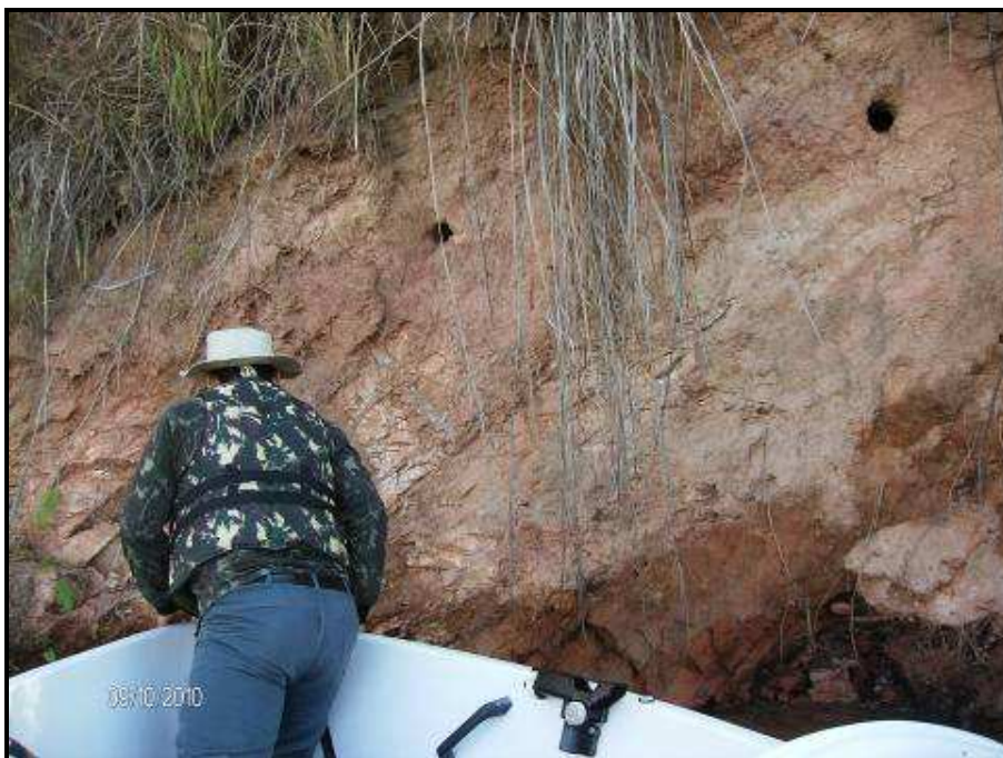
FOTO 14 – DETALHE DA FOTO ANTERIOR (PONTO B).
