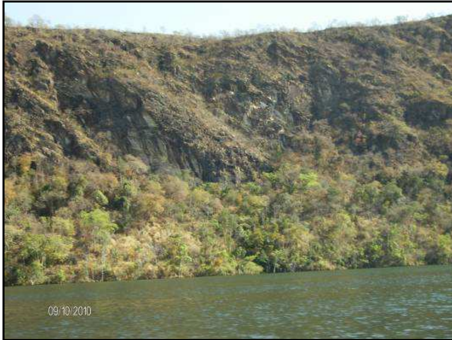
FOTO 12 – MARGEM DIREITA DO RIO TOCANTINS (PONTO 14). ESCARPAS COM TALUDES NEGATIVOS, QUEDAS LOCALIZADAS DE BLOCOS E LASCAS E PRESENÇA DE CONES DE COLÚVIO/TÁLUS NA MEIA-ENCOSTA E BASE DO TALUDE.
