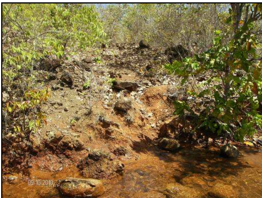
FOTO 43 – DETALHE DO PONTO F, COM INFLUÊNCIA DE ÁREA DEGRADADA (ANTIGA ESTRADA) EM SOLO RESIDUAL COLUVIONAR, MUITO ERODÍVEL. EM EVOLUÇÃO DE SEUS PROCESSOS EROSIVOS/ASSOREAMENTO A MONTANTE DA BARRAGEM, NA MARGEM ESQUERDA.
