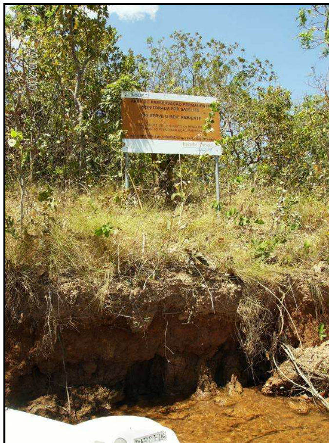
FOTO 38 – ILHA 75. EROSIÃO POR EMBATE DE ONDAS EM TALUDES MARGINAIS DE DIVERSAS ILHAS NO RESERVATÓRIO. NOTAR A ERODIBILIDADE DO SOLO SUPERFICIAL DE ROCHA XISTOSA/GNAISSE (?). ASSOREAMENTO EM PROGRESSO.
