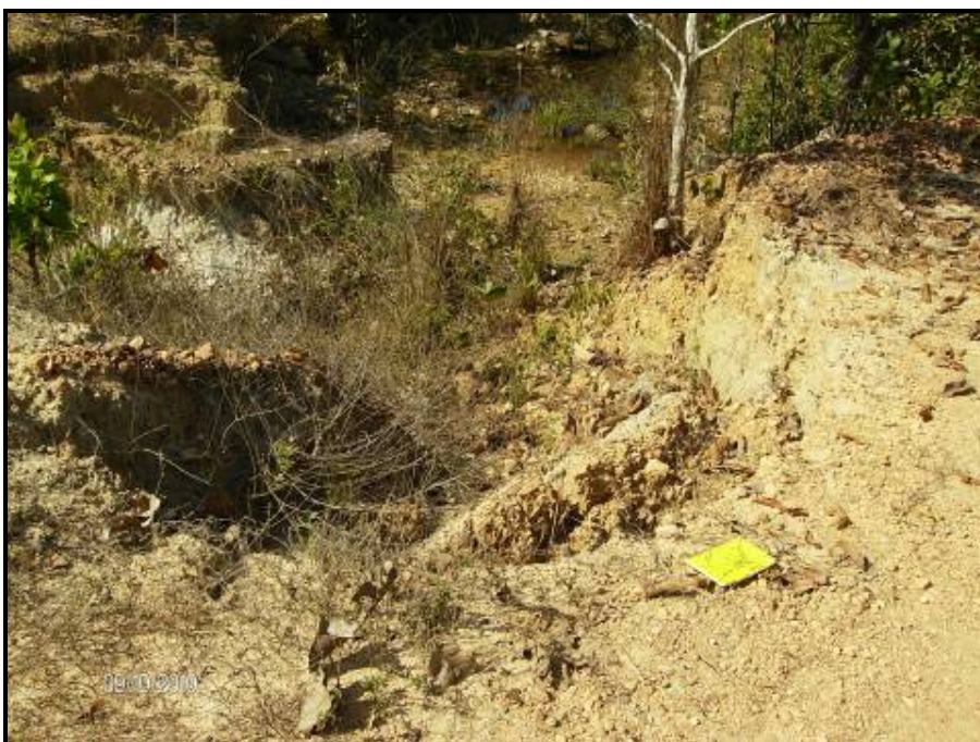
FOTO 19 – VISTA DA TRINCA NO LE DO CORPO DE ATERRO DA ESTRADA (PONTO 26).
