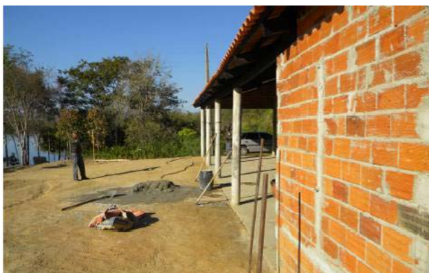
e) Construção de edificação irregular Fotos: Mirllan
