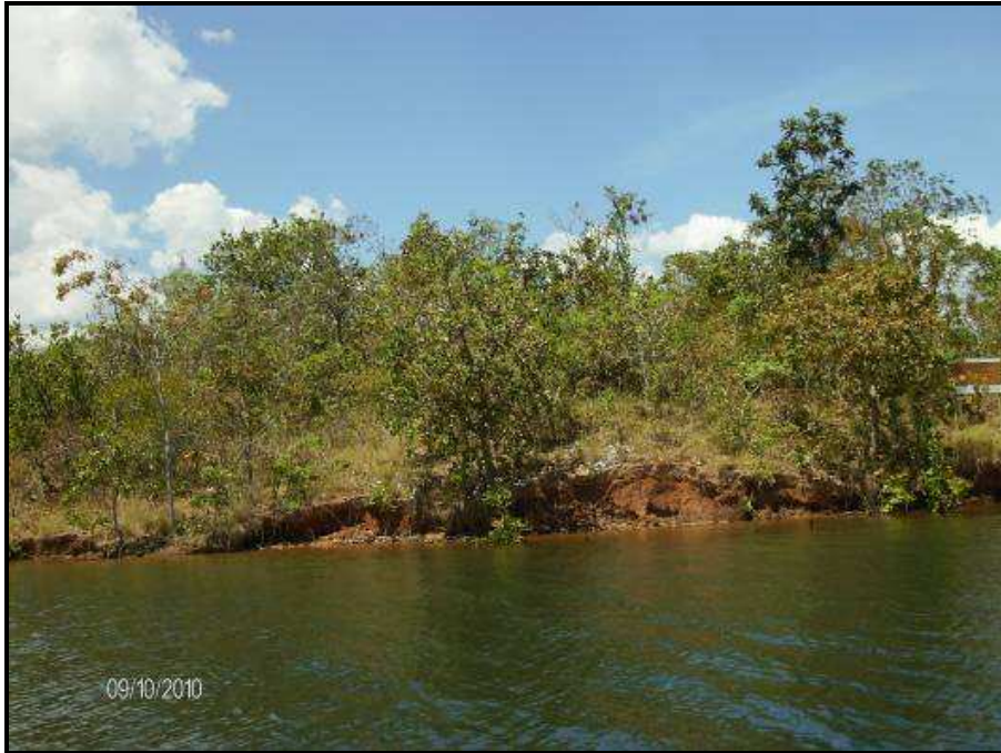
FOTO 37 - PONTO D, TALUDES MARGINAIS COM EROSÕES POR AÇÃO DE ONDAS. DIVERSAS ILHAS APRESENTAM ESSE PASSIVO GEOTÉCNICO LOCALMENTE, CONTRIBUINDO AO ASSOREAMENTO DO RESERVATÓRIO.
