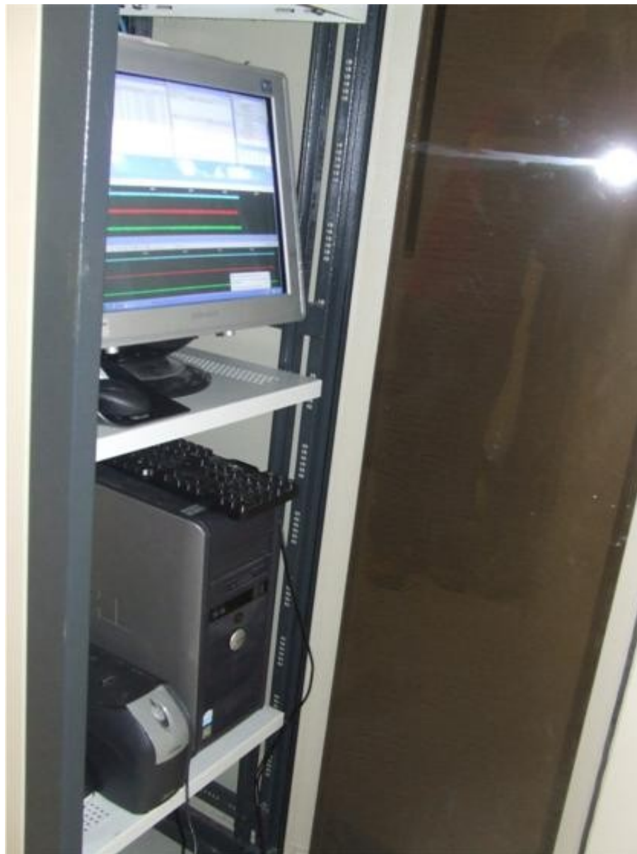
Figura 03 – Imagem do computador utilizado para gravar os dados provenientes das estações sismográficas SSV2 e CAN3, alojado em um rack . Ao lado da CPU, observa-se o nobreak da estação.
