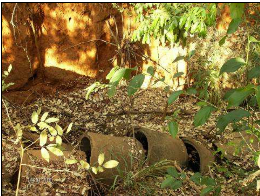
FOTO 6 – MARGEM ESQUERDA DO RIO BONITO - DESÁGÜE DA REDE PLUVIAL DA VILA DE FURNAS.
