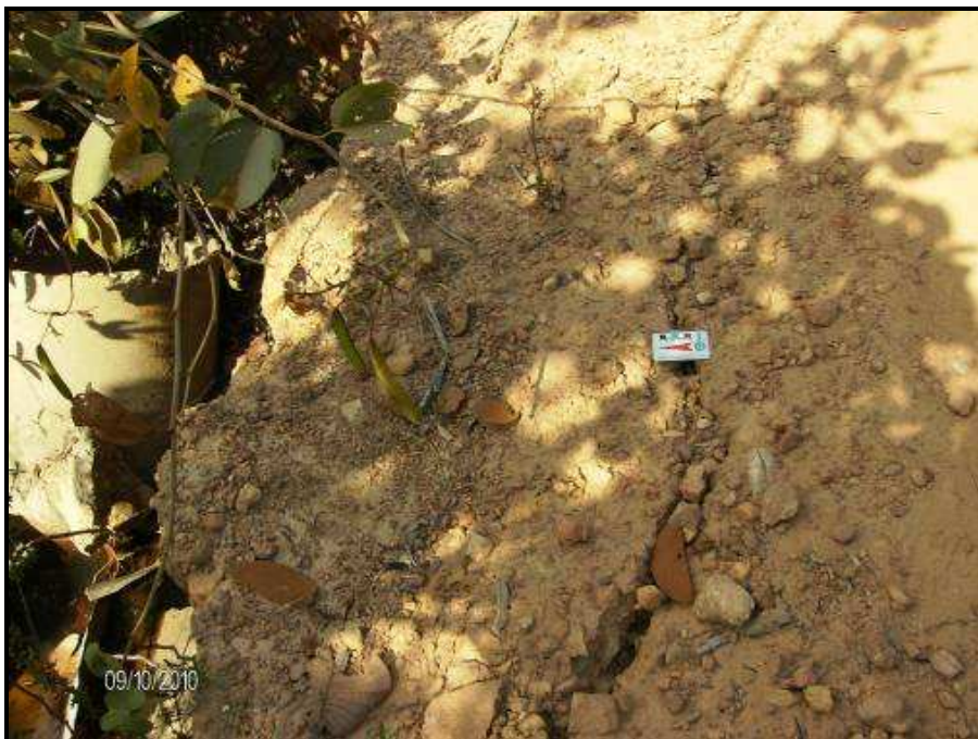
FOTO 18 – DETALHE DA TRINCA DE TRAÇÃO NO CORPO DE ATERRO DA ESTRADA (PONTO 26).
