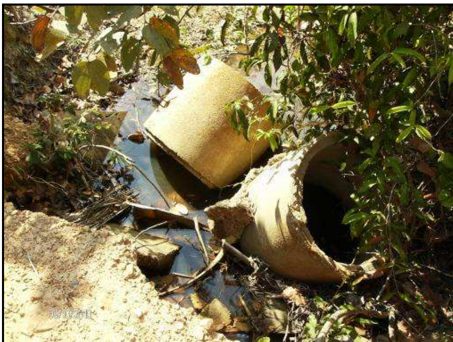
FOTO 17 – DETALHES DAS ESTRUTURAS DE DRENAGEM, INADEQUADAS E DETERIORADAS, A JUSANTE DO CORPO DE ATERRO DA ESTRADA (PONTO 26).
