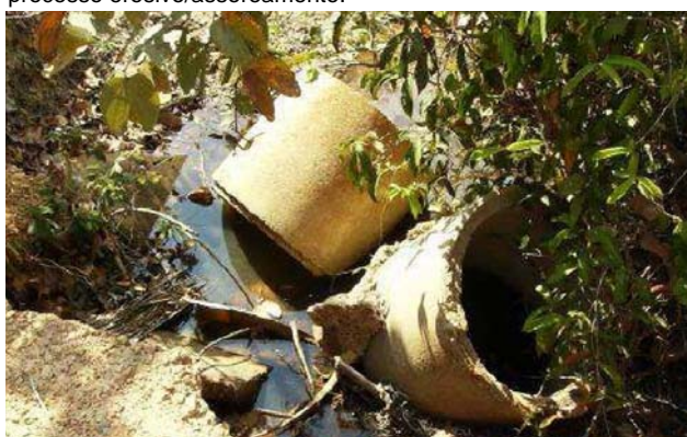
c) Próximo à foz do Rio das Pedras (ponto 26), área intensamente degradada com erosões e assoreamento acelerado.
