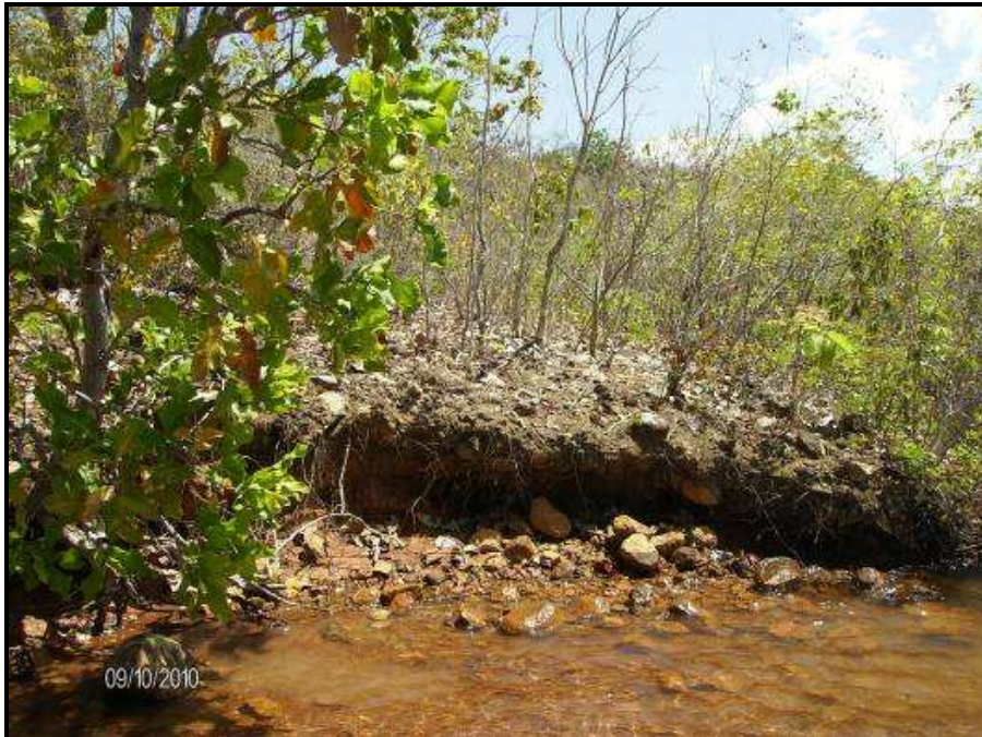
FOTO 42 – PONTO F - EROSÕES/SOLAPAMENTO/ASSOREAMENTO POR EFEITO DE ATAQUE DE ONDAS DO RESERVATÓRIO.
