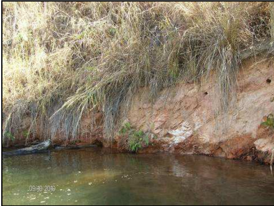
FOTO 13 – MARGEM ESQUERDA DO RIO TOCANTINS (PONTO B). EROSÕES PROVOCADAS POR EMBATE DE ONDAS EM MATERIAL MUITO INSTÁVEL DE BAIXA COESÃO, PROVOCANDO ESCORREGAMENTO DE MATERIAL SAPROLÍTICO/ROCHA XISTOSA/BANDADA E ALTERADA, EM TALUDE SV. ASSOREAMENTO EM PROGRESSO.
