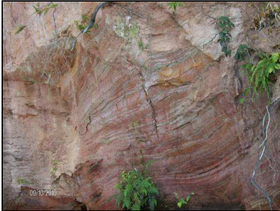
FOTO 23 – PONTO 16 - NOTAR A ESTRUTURA RELIQUIAR DA ROCHA NO MATERIAL SAPROLÍTICO, MUITO ERODÍVEL. ASSOREAMENTO EM PROGRESSO.
