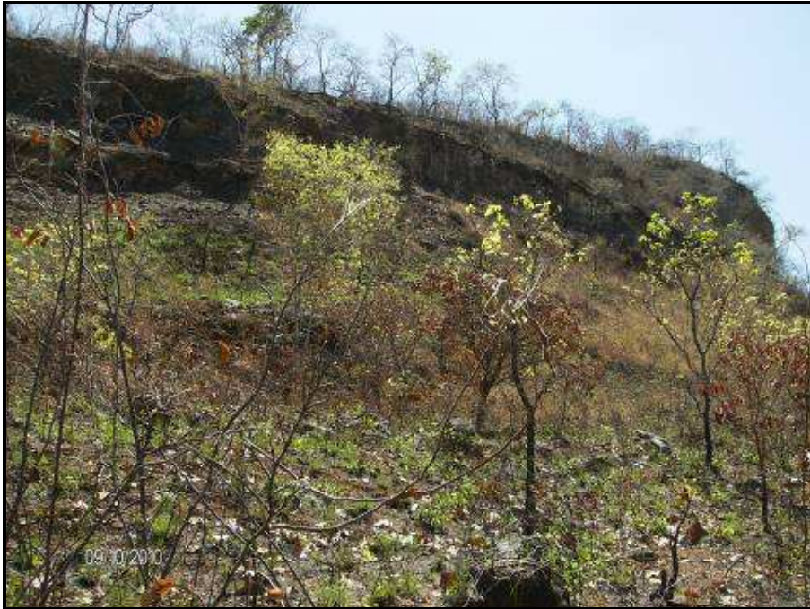
FOTO 32 – VISTA FRONTAL DA “CUESTA”, PODENDO-SE NOTAR OS DEGRAUS DE ABATIMENTO EM SUA PORÇÃO SUPERIOR, FORMANDO 3 A 4 PATAMARES DESCONTÍNUOS. A PARTE MÉDIO-INFERIOR DO TALUDE É SUSTENTADA SUPERFICIALMENTE POR COLÚVIO/TÁLUS, APARENTEMENTE EM PERFIL DE EQUILÍBRIO. PONTO 15.
