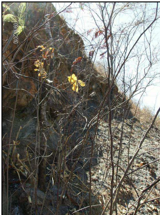
FOTO 28 – VISTA PARA MONTANTE DO MATERIAL COLUVIAL/TÁLUS, CONFORMANDO A ENCOSTA CÔNCAVA DO TALUDE MARGINAL. NOTAR O DEGRAU DE ABATIMENTO NA PARTE MEDIANA DO TALUDE. PONTO 15.
