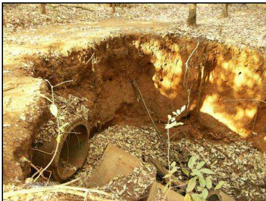
FOTO 5 – MARGEM ESQUERDA DO RIO BONITO - DESÁGÜE DA REDE PLUVIAL DA VILA DE FURNAS.
