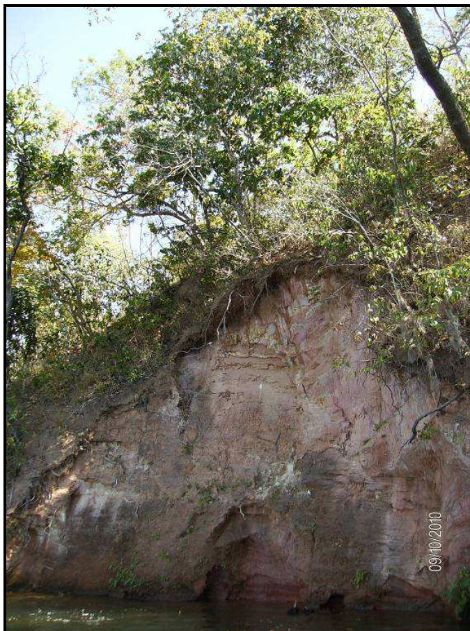
FOTO 24 – PONTO 16 - NOTAR A VERTICALIDADE DO TALUDE (BARRANCA) COM ESCORREGAMENTOS POR SOLAPAMENTO DA BASE DO TALUDE POR AÇÃO DE ONDAS DO RESERVATÓRIO. ASSOREAMENTO PROGRESSIVO.
