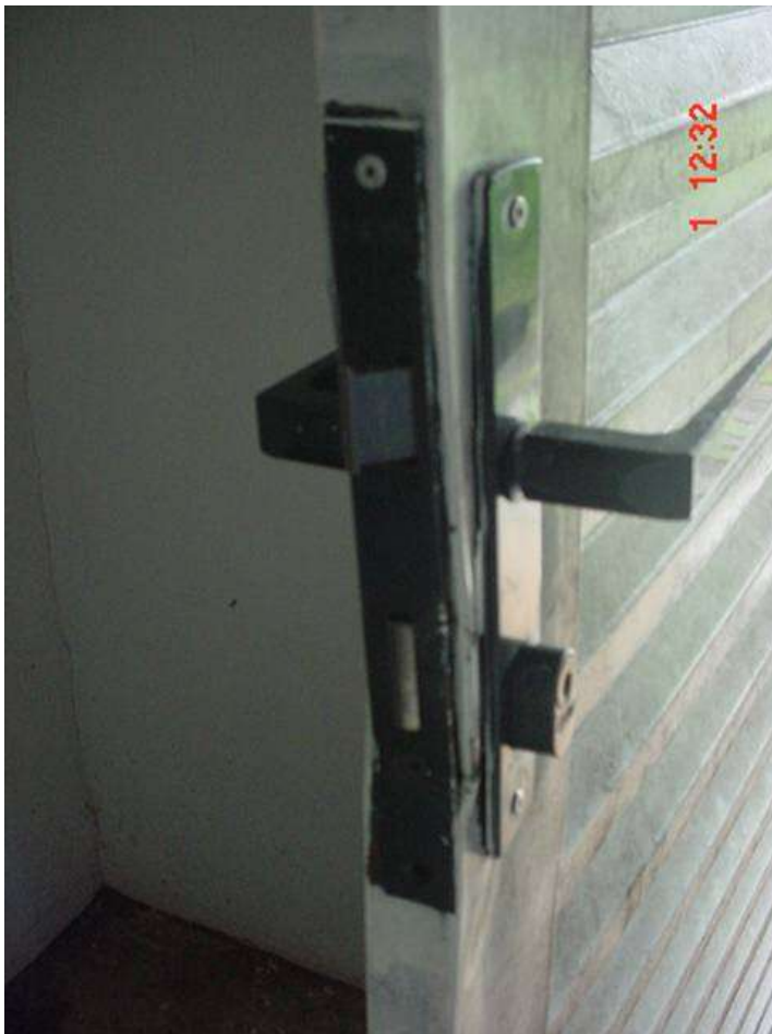
PORTA DE ACESSO AO ABRIGO DOS EQUIPAMENTOS DA ESTAÇÃO DE SISMOLOGIA CAN 2 COM EVIDÊNCIA DE ARROMBAMENTO.
