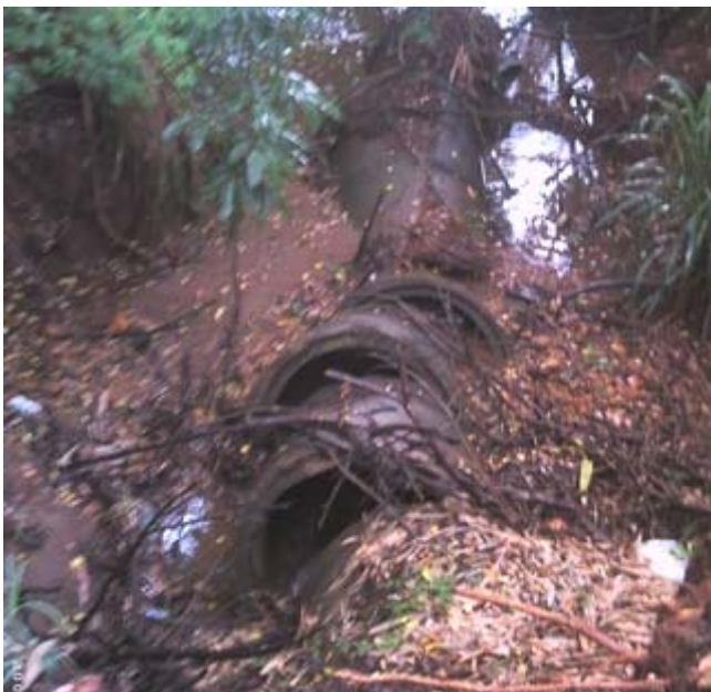
Foto 21: bueiro desmoronado e erosão.
