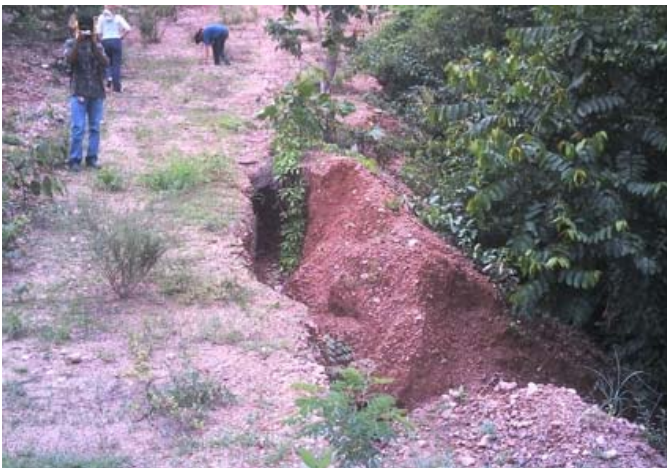
Foto 14 (acima): aterro com erosão.
