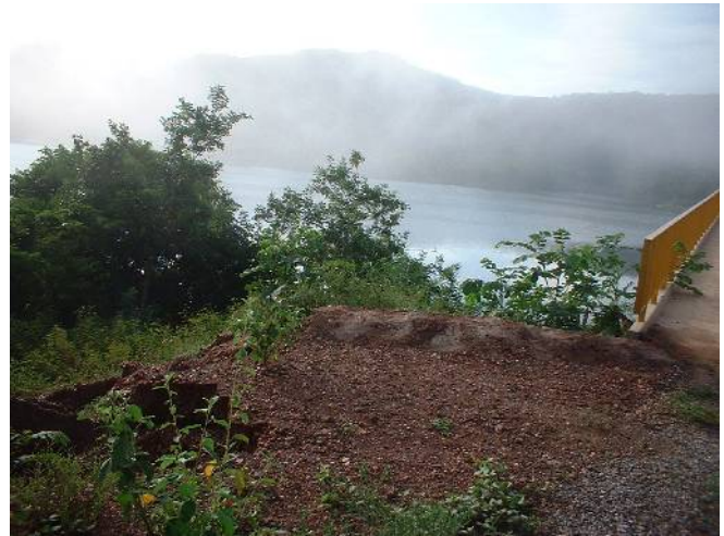
Foto 2: Aterro de encontro da ponte da Rodovia GO-239 em processo de erosão.
