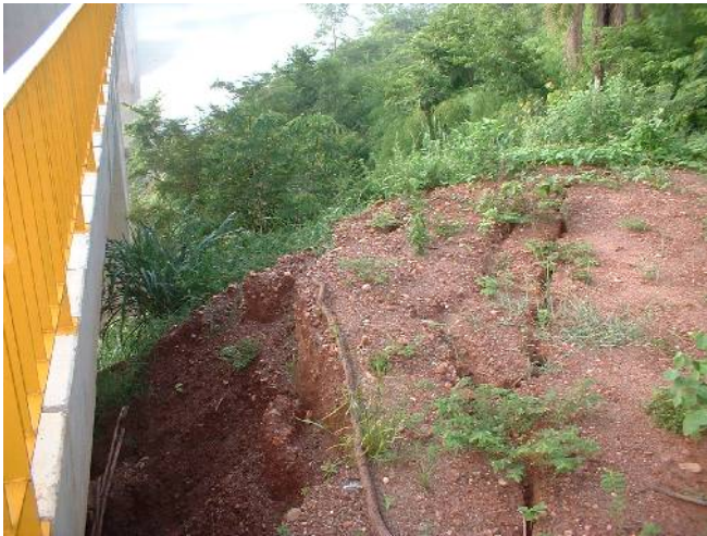
Foto 1: Aterro de encontro da ponte da Rodovia GO-239 com trincas de tração.
