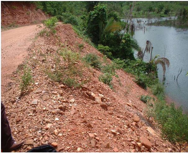
Foto 13: Talude da estrada marginal (GO-239) com erosão - Córrego do Gim. Situação em Novembro/2004.
