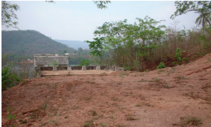
Foto 4: Cabeceira da ponte da rodovia GO-239. Notar aterro estável, porém sujeito a erosão.
