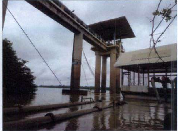
Foto nº 31 - Sistema de captação de água da cidade de Boa Vista.
