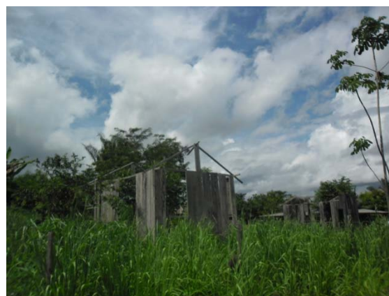
Figura - 6 – Domicílio em construção abandonada – Vila Izabel – 6ª Campanha.
