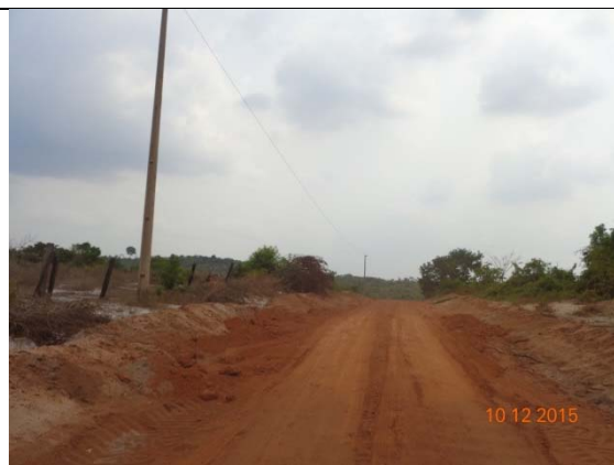
Figura 15 - Trecho do Travessão Km 45 com obras de manutenção a 300 m da BR.
