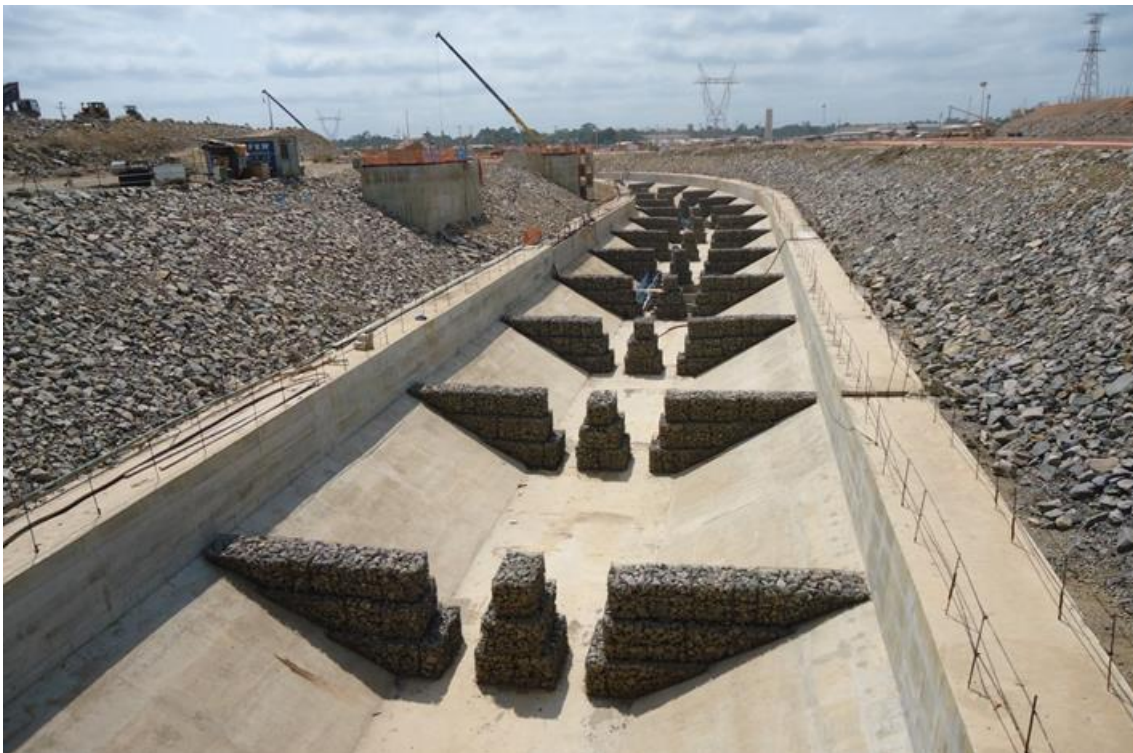
Figura 13.3.6 - 4 – Vista dos Defletores do Sistema de Transposição de Peixes.
