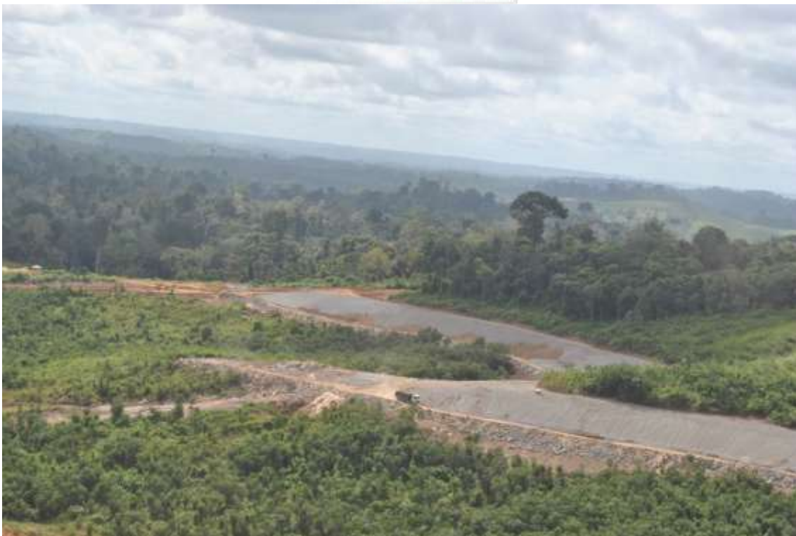
Figura 10.4 - 1 – Vista geral de um trecho de construção de rip-rap no Espigão de Arenito, ainda no primeiro trimestre de 2015.
