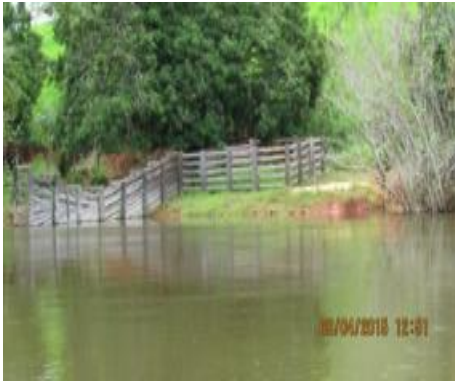
Inspeção Trimestral 13 (abril/2015 - cheia): Área aparentemente estável, devido ao aumento do nível do rio observa-se a cobertura do talude em relação à vistoria anterior.
