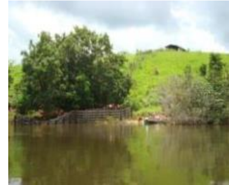
Inspeção Trimestral 9 (abril/2014 - cheia): Área aparentemente estável sob o ponto de vista geotécnico, observando-se ainda uma redução da exposição do talude, devido à elevação do nível do rio.
