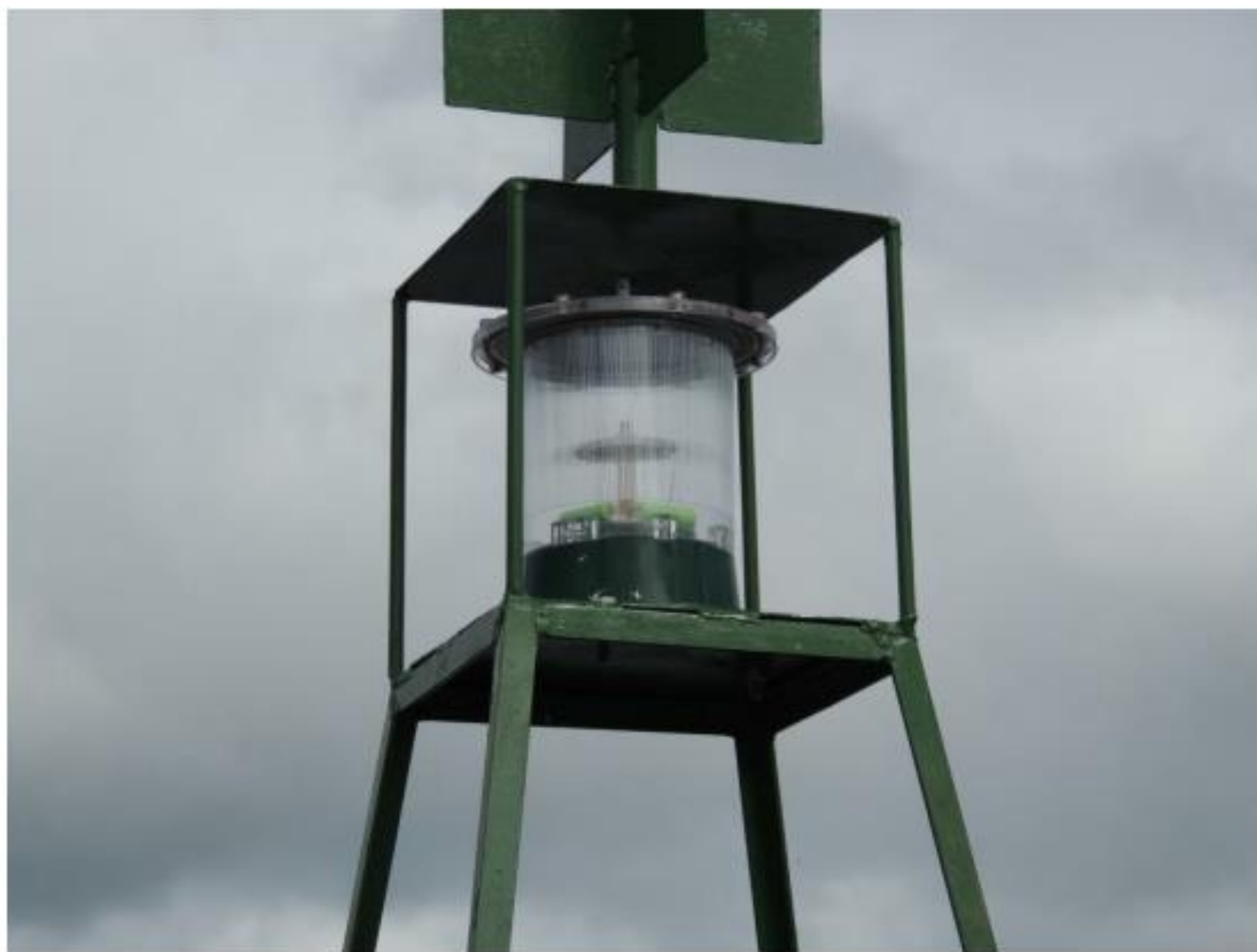
Figura 14.2.4 - 3 - Detalhe do sistema de sinalização noturna (lâmpada) da boia da figura anterior.
