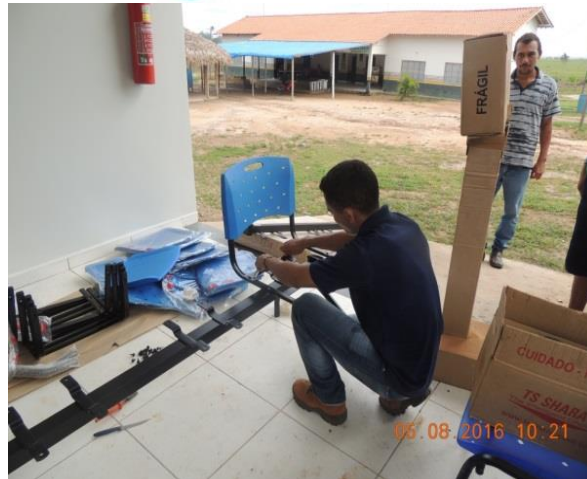
Figura 10.1.2.2-12 - Montagem de equipamento UBSI Tipo I da Aldeia Boa Vista AI Juruna do Km 17.
