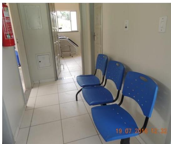
Figura 10.1.2.2-5 – Sala de espera da UBSI Tipo I Aldeia Furo Seco - TI Paquiçamba.
