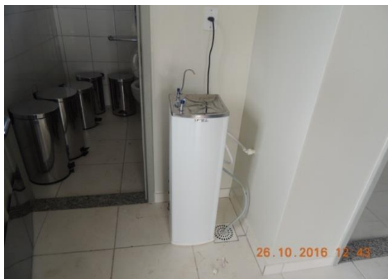
Figura 10.1.2.2-20 – Equipamentos da UBSI Tipo I - Aldeia Raio de Sol – TI Apyterewa.
