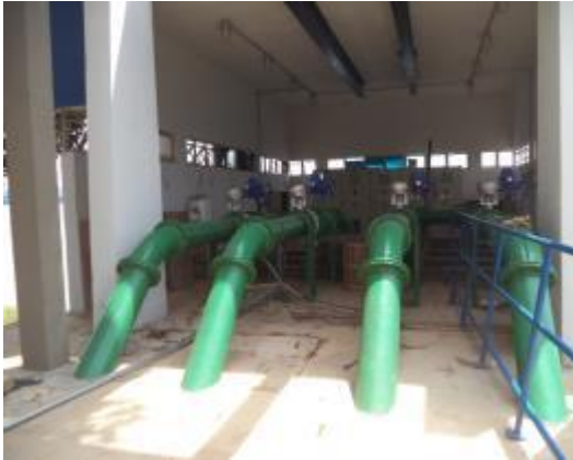
Figura 5.1.9-22 – Dutos de recalque da captação
