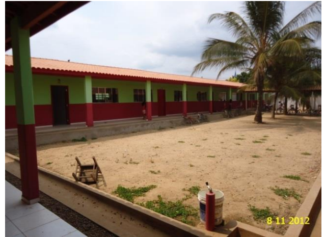
Figura 84 - Conclusão da obra de reforma com ampliação da EMEF Paraíso - Brasil Novo/PA.
