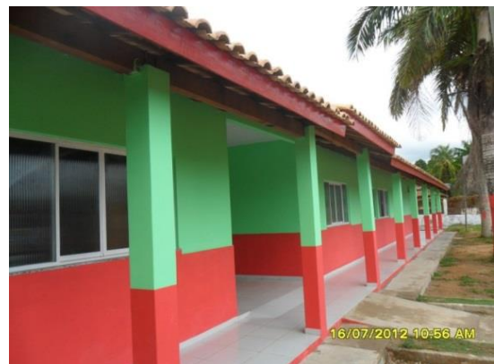
Figura 92 - Conclusão da obra de reforma com ampliação da Creche Criança Esperança - Brasil Novo/PA.
