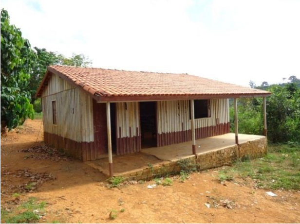
Figura 59 - Escola Nossa Senhora Aparecida I antes da obra de reforma com ampliação - Vitória do Xingu/PA.
