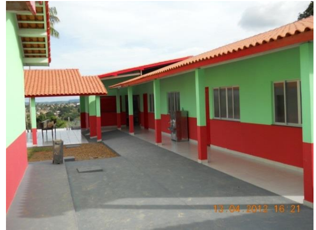
Figura 90 - Conclusão da obra de reforma com ampliação da EMEF Padre Léo Schneider - Brasil Novo/PA.
