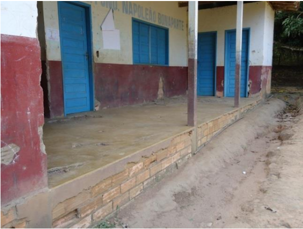
Figura 61 - Escola Napoleão Bonaparte antes da obra de reforma com ampliação - Vitória do Xingu/PA.
