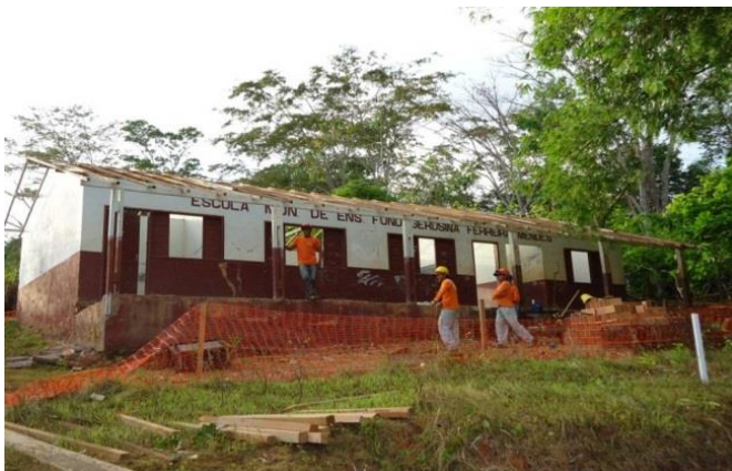
Figura 57 - Escola Gerosina antes da obra de reforma com ampliação - Vitória do Xingu/PA.
