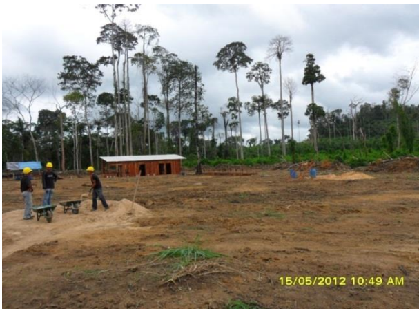
Figura 101 - Terreno antes da construção da EMEF PA Ressaca de - Senador José Porfírio/PA.
