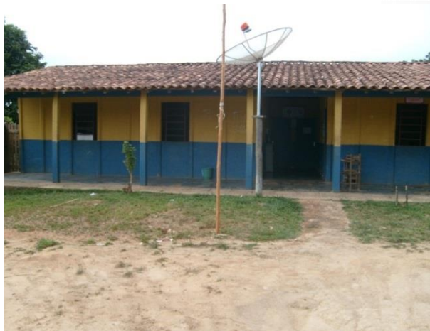
Figura 47 - Escola Santa Helena antes da obra de reforma com ampliação - Vitória do Xingu/PA.
