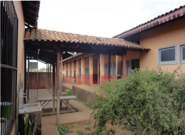
Figura 13 - EMEF Saint Clair Passarinho antes da obra de reforma com ampliação - Altamira/PA.
