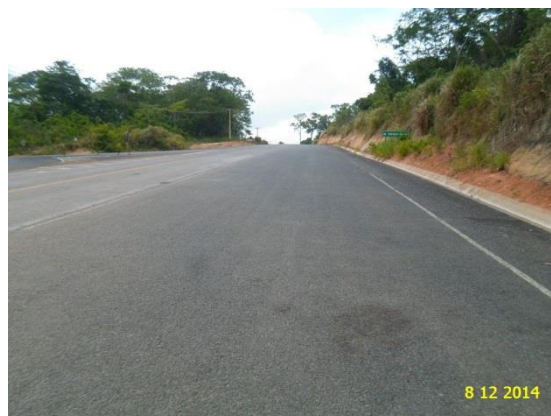
Figura 2 – Próximo ao km 20, a partir da BR 230 foi realizado recapeamento da pista, e recuperação da drenagem, neste ponto.
