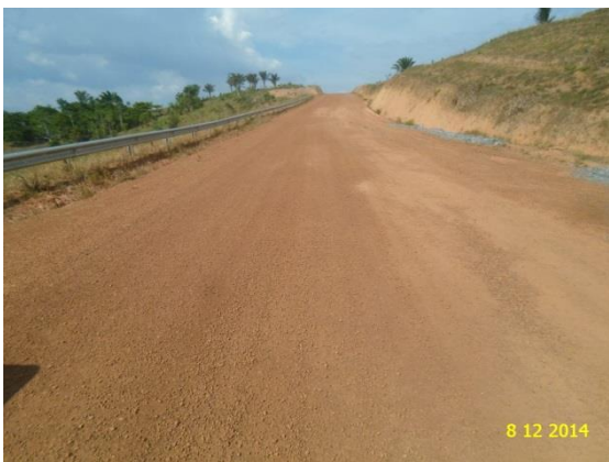
Figura 3 – O travessão corta o sitio Belo Monte, não há acesso de moradores está em boas condições de trafego.
