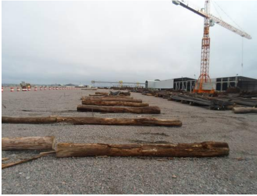
Figura 12.1.2 - 08 – Uso interno - toras no pátio de ferro, Unidade Belo Monte - Coordenada UTM: Zona 22 M 414781/9653245.
