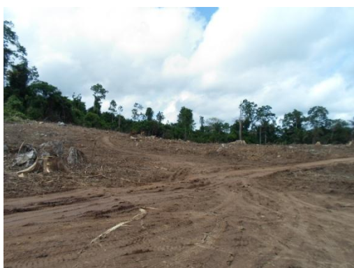
Figura – 12.1.1 - 14 – Área após realização da atividade de limpeza de resíduos, Unidade Belo Monte - Coordenadas em UTM 22M: 410188 / 9648869
