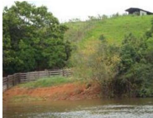
Inspeção Trimestral 8 (janeiro/2014 - enchente): Área aparentemente estável, mesmo com a elevação do nível do rio, notando-se apenas uma redução da exposição do talude.
