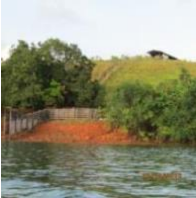
Inspeção Trimestral 7 (outubro/2013 - seca): Área aparentemente estável, sem mudança de risco geotécnico em relação aos valores originais.
