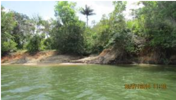
Inspeção Trimestral 10 (julho/2014 - vazante): Área potencialmente estável. Maior exposição do talude em relação à vistoria anterior devido ao rebaixamento do nível do rio Xingu em relação à vistoria anterior.
