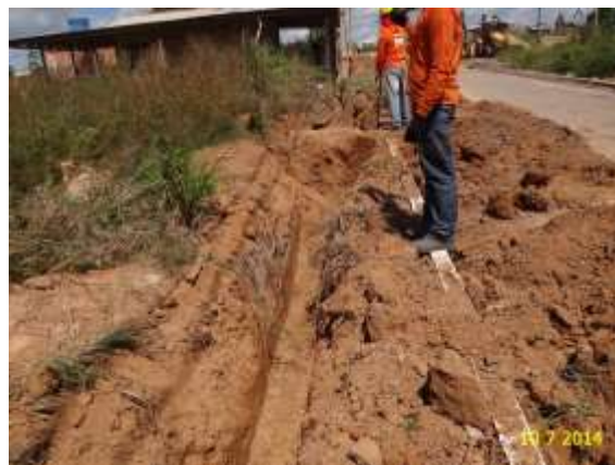
Figura 5.2.19 - 2 – Fechamento das valas após a instalação da tubulação em complementação à rede.
