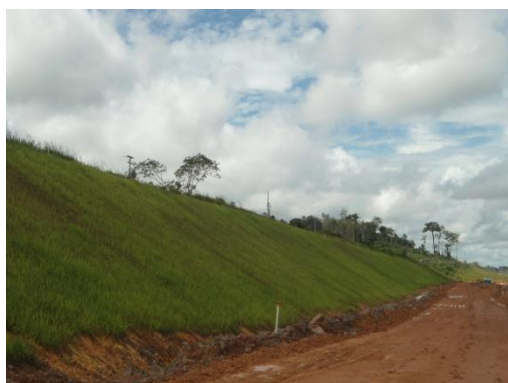
Figura 3.2 – 15 - Vista geral após a realização da atividade de aplicação de hidrossemeadura, km 9,5, Unidade Canais e Diques.
