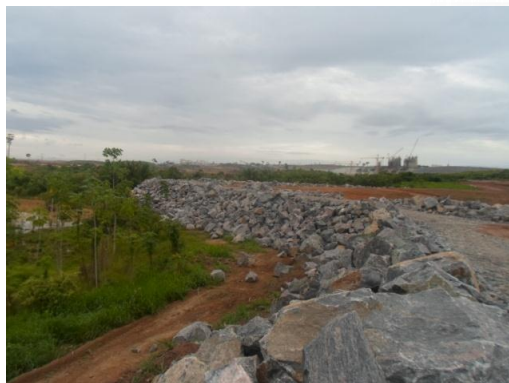
Figura 3.2 – 9 - Finalização da implantação de enrocamento de talude, Bota Fora 05, Unidade Belo Monte.
