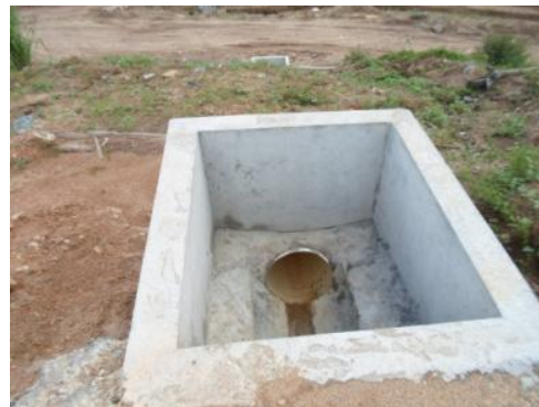
Figura 3.2 – 6 - Descida d'água implantada no BF-03/06, Unidade Belo Monte.
