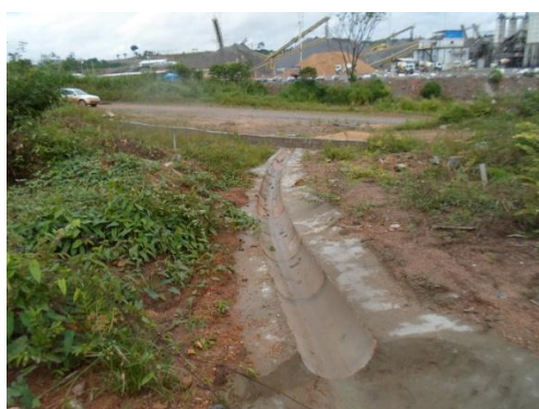
Figura 3.2 – 3 - Canaletas de drenagens após a limpeza das mesmas, Bota Fora 03/06, Unidade Belo Monte.
