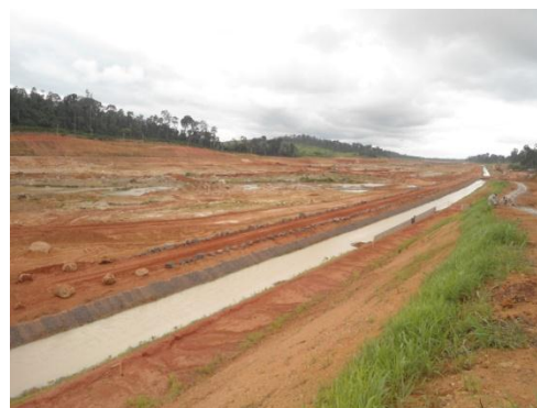
Figura 3.2 – 8 - Vista geral do canal de derivação durante o período de execução das canaletas de drenagem, Unidade Canais e Diques.
