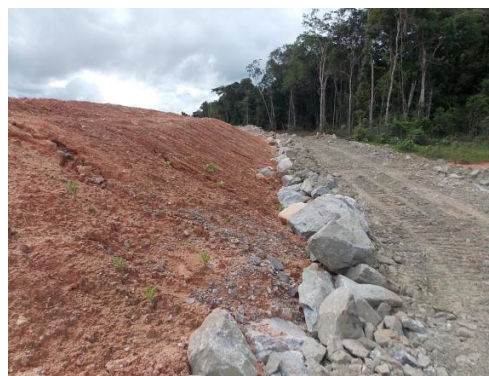
Figura 3.2 – 34 - Vista parcial do BF-IPJ, em processo de correção das erosões – Unidade Pimental.
