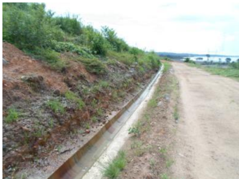
Figura 3.2 – 5 - Canaleta de drenagem ao longo do Bota Fora 03/06, Unidade Belo Monte.
