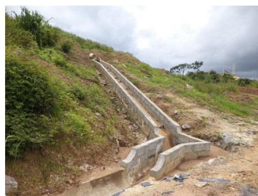
Figura 3.2 – 4 - Descida d'água no BF 03/06, Unidade Belo Monte.
