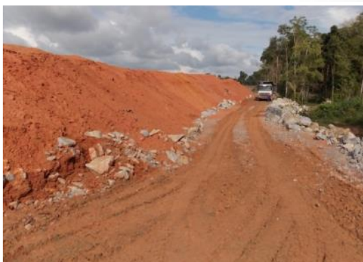
Figura 3.2 – 33 - Vista parcial do BF-IPJ, em processo de correção das erosões – Unidade Pimental.
