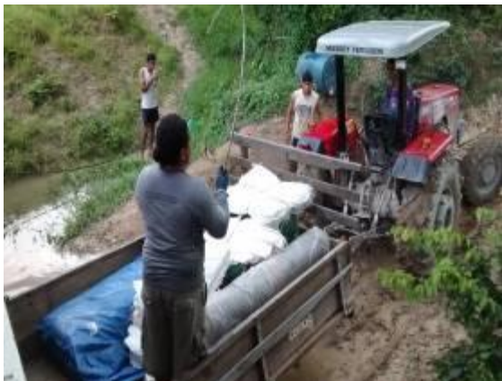
Figura 7.2 – 66 - Entrega do material para construção do galpão – TI Xipaya (Aldeia Tukamã). Em: 05.02.2015.
