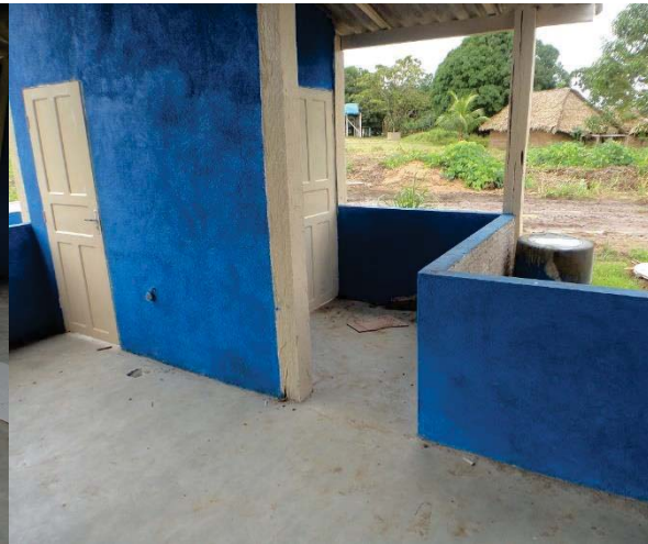
Figura 1834: Local para instalação do catitu – Aldeia koatinemo (24/03/2015).
