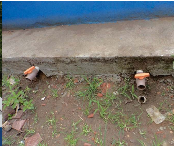
Figura 2035: Instalação hidráulica faltando ligação – Aldeia Koatinemo (24/03/2015)
