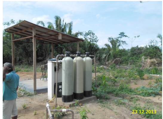
Figura - 4 – Filtros para purificação da água instalados.
