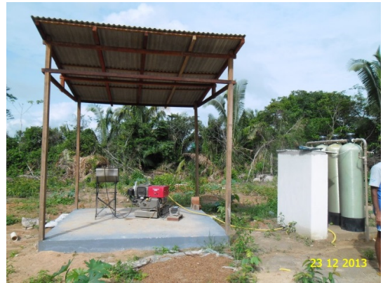
Figura - 2 – Grupo gerador de 10 kva instalado para energização do sistema.
