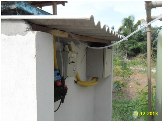
Figura - 3 – bomba dosadora de cloro e comando elétrico.
