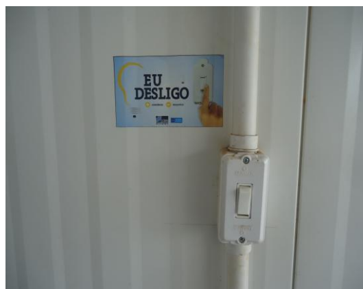
Figura 3.5 - 3 – Adesivo instalado na Unidade Sítio Belo Monte
