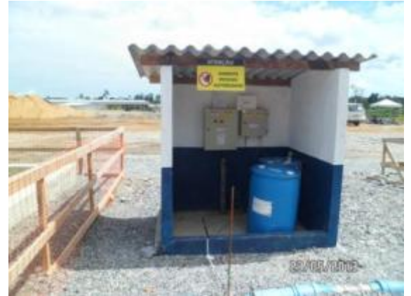
Figura - 8 - Casa de produto químico, controle de pH
