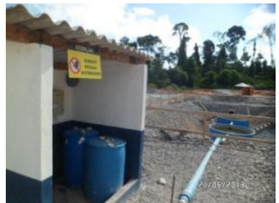
Figura - 12 - Casa de produto químico, controle de pH
