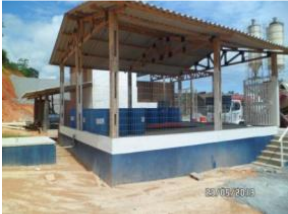
Figura - 7 - Depósito de produtos químicos
