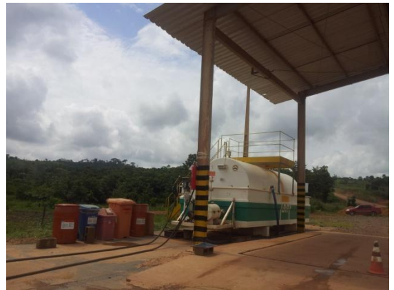
Figura - 8 – Plant de combustível acesso Trav-55 – BV
