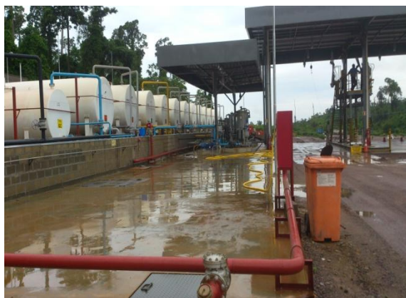
Figura - 5 – Posto de Combustível – Sítio Canais
