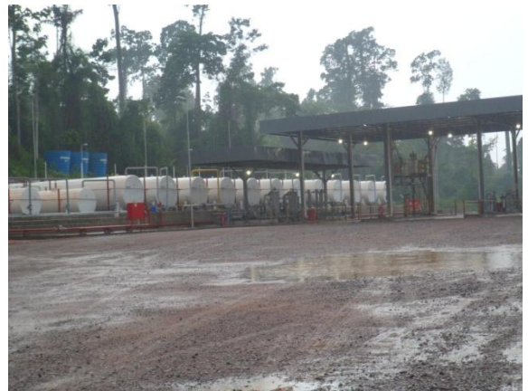
Figura - 4 – Posto de combustível – Sítio Canais
