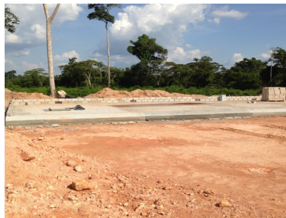
Figura - 12 – Construção da rampa de lavagem de equipamentos das subcontratadas – Bela Vista
