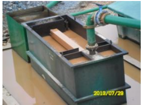
Figura 4 – Caixa Separadora de Água e Óleo – Sitio Pimental
