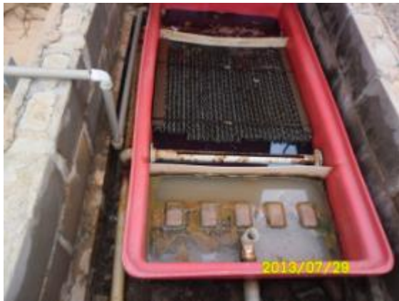
Figura 3 – Caixa Separadora de Água e Óleo – Sitio Pimental
