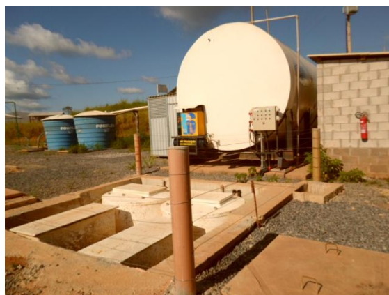
Figura - 3 - Estação de tratamento de efluente Seikin; - Bela Vista
