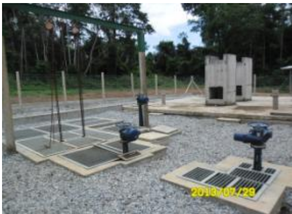
Figura - 7 - Estação elevatória de efluentes sanitários do canteiro de Pimental
