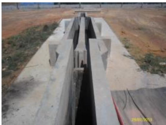
Figura - 5 - Calha parshall, medidor de vazão de efluentes sanitários do canteiro de Pimental
