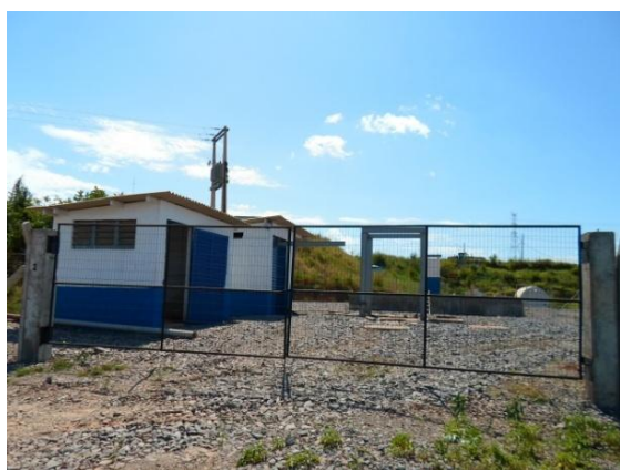
Figura - 11 - - Elevatória de esgoto do Sitio Belo Monte
