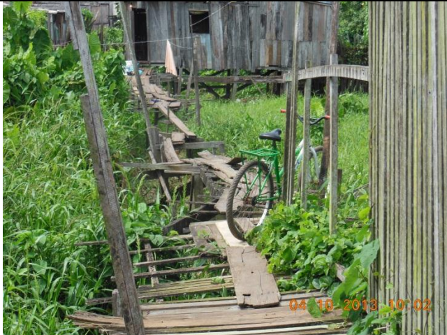
Foto – 63 – Ausência de passarela transitável.
