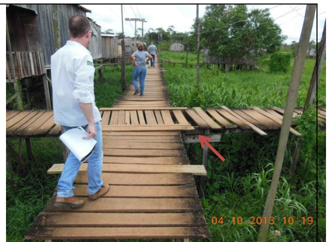
Foto 22 - Pontos de fragilidade na estrutura.
