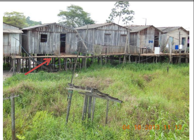
Foto 14 - Trecho de acesso lateral as casas esta ruim.
