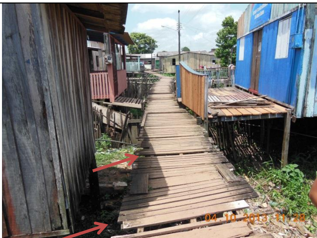
Foto 37 - Ramal 02 - Estrutura em bom estado com falhas na pista
