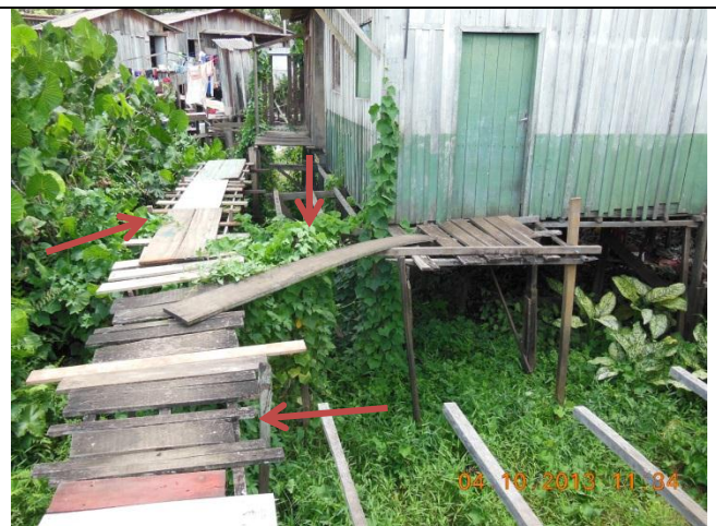
Foto 44 - Acesso às casas bastante irregular
