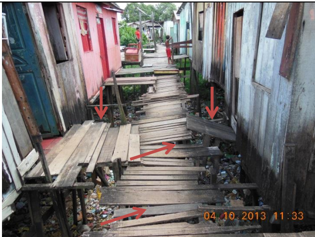
Foto 41 - Parte final da passarela bastante danificada
