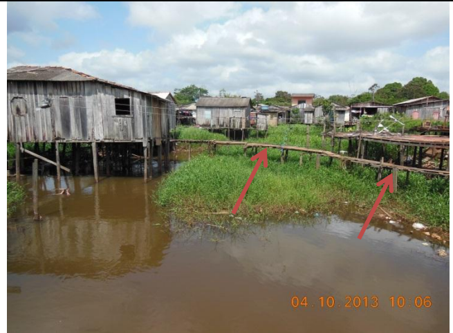
Foto 62 – Acesso secundário - Estrutura condenada.
