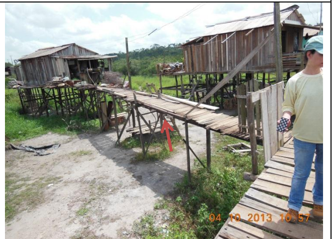
Foto 08 - Estrutura frágil de sustentação.
