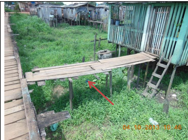
Foto 19 - Passarela de acesso as casas bastante frágil.
