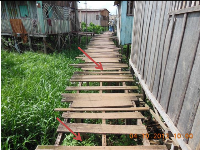
Foto 61 – Pista em estado precário de conservação
