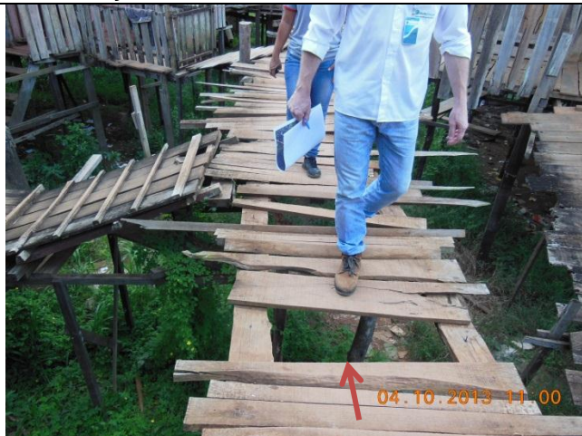
Foto 07 - Trecho do acesso principal ruim
