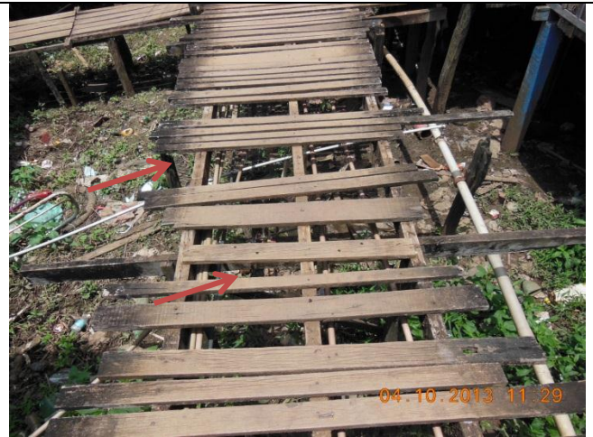
Foto 40 - Passarela principal em estado precário de conservação.
