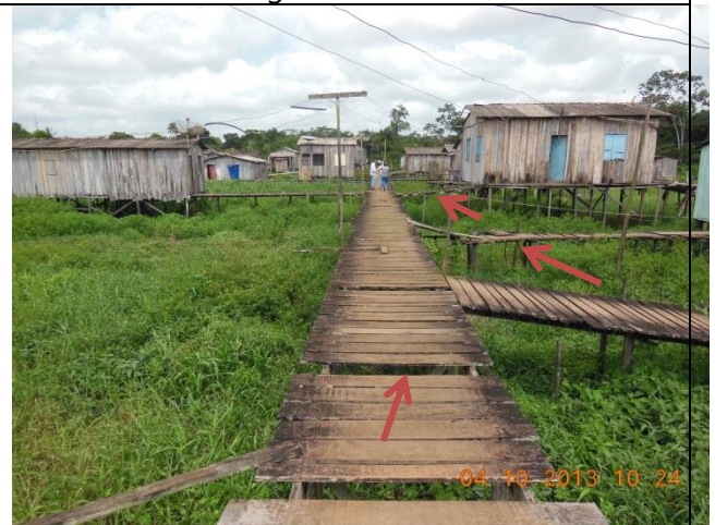
Foto 28 – Falta de tábuas na pista.
