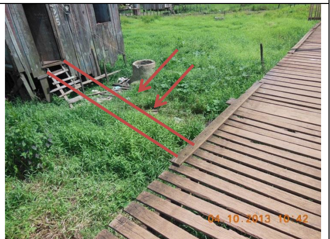
Foto 18 - Falta de acesso da passarela principal até a residência.
