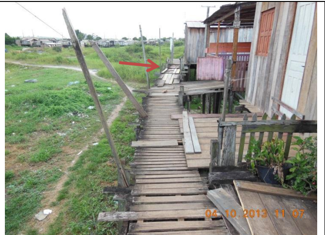
Foto 10 - Passarela com manutenção precária.
