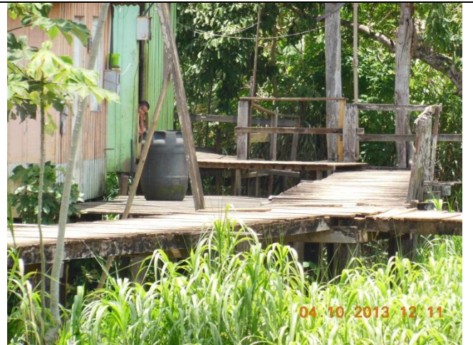
Foto 56 - Ramais necessitam de reparos.
