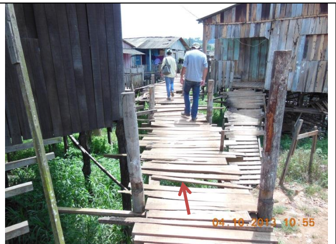
Foto 02 – Condição precária de manutenção.
