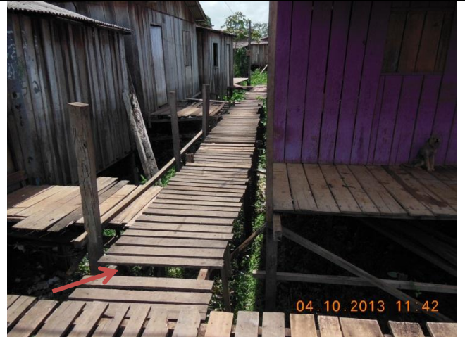
Foto 48 - Tábuas faltantes na pista principal
