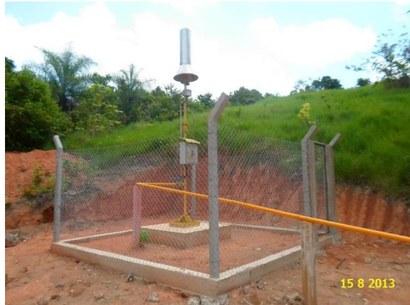
Figura 01 – Queimador de biogás da Estação de Tratamento de Esgoto em Belo Monte do Pontal.
