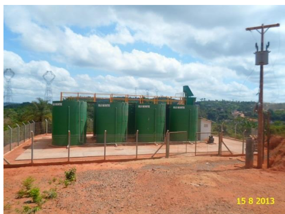
Figura 05 – Estação de tratamento de esgoto instalada, em Belo Monte.
