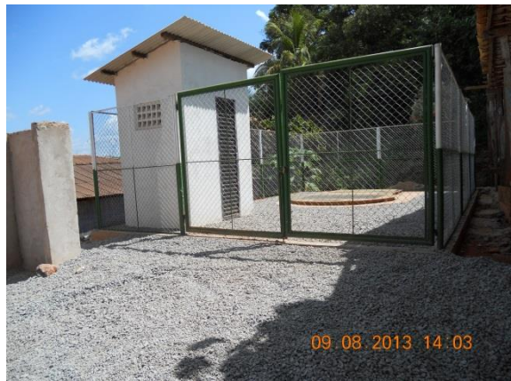
Figura 03 – Estação elevatória de esgoto 01, em Belo Monte do Pontal.
