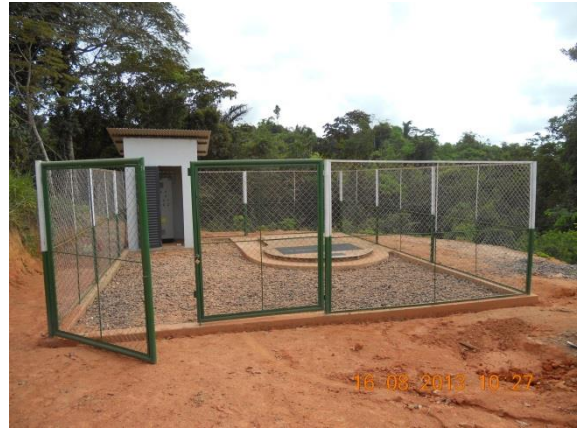
Figura 02 – Estação elevatória de esgoto 02, com instalação do CCQ em Belo Monte do Pontal.
