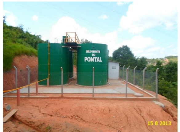
Figura 04 – Estação de tratamento de esgoto instalada, em Belo Monte do Pontal.
