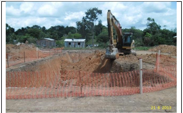
Figura - 8 – Início da escavação para implantação do sistema de tratamento de esgoto – ETE B
