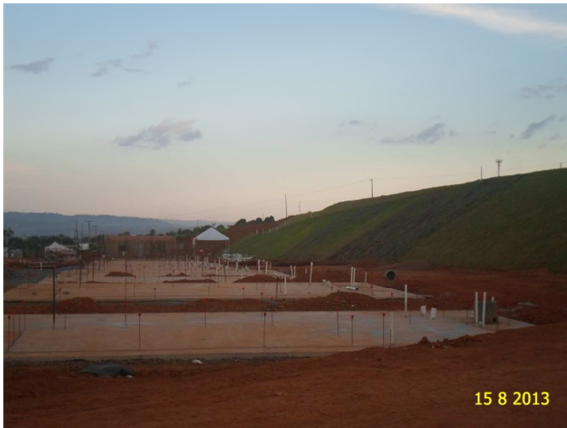
Figura - 3 – Construção de fundação, em radier, para a execução das casas (RUC Jatobá).
