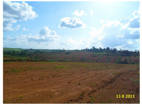
Figura - 8 – Limpeza de área com remoção da camada vegetal (RUC Casa Nova).
