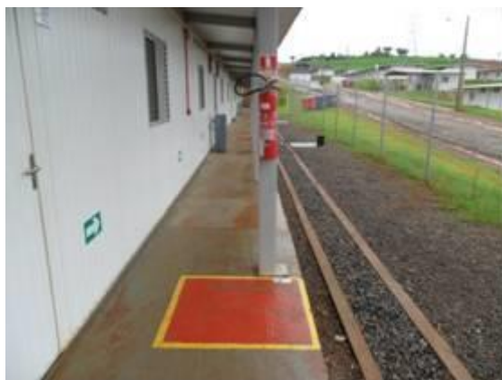
Figura - 6 – Equipamento de combate a incêndio
