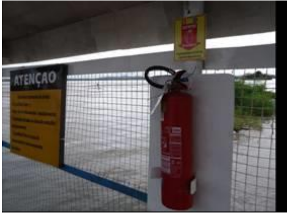
Figura - 7 – Equipamento de combate a incêndio
