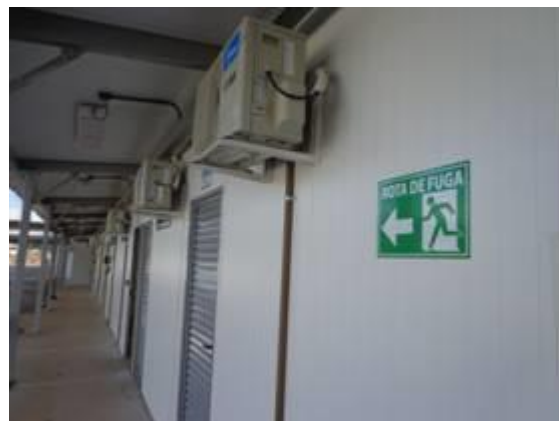
Figura - 2 – Sinalização de rota de fuga em caso de emergência
