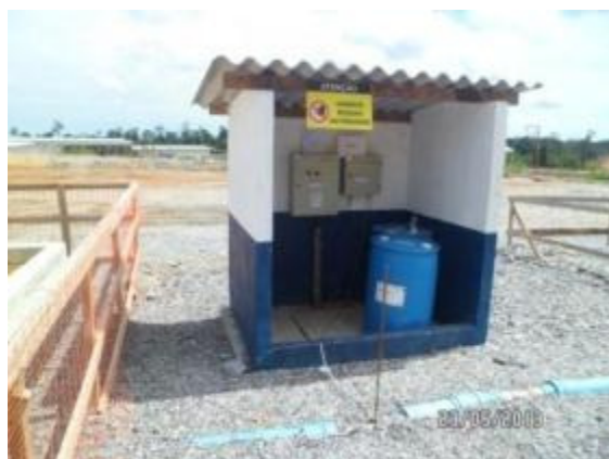
Figura - 11 - Corretor de ph da central de concreto
