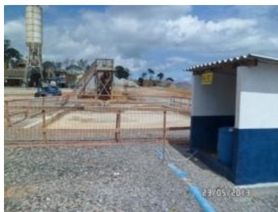
Figura - 10 - Caixa de decantação da central de concreto
