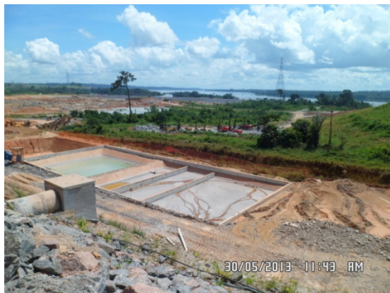
Figura - 7 - Caixa de decantação Industrial
