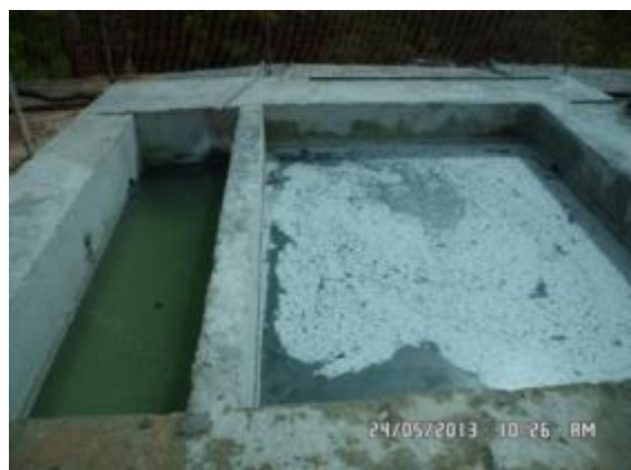
Figura - 12 - Caixa de decantação da central de concreto
