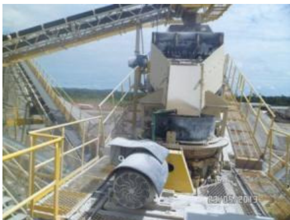
Figura - 9 - Sistema de aspersão de água para controle de material particulado na central de britagem
