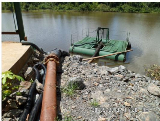
Figura - 1 – Captação de água bruta no Rio Xingu da ETA de 100m 3 /h – Belo Monte
