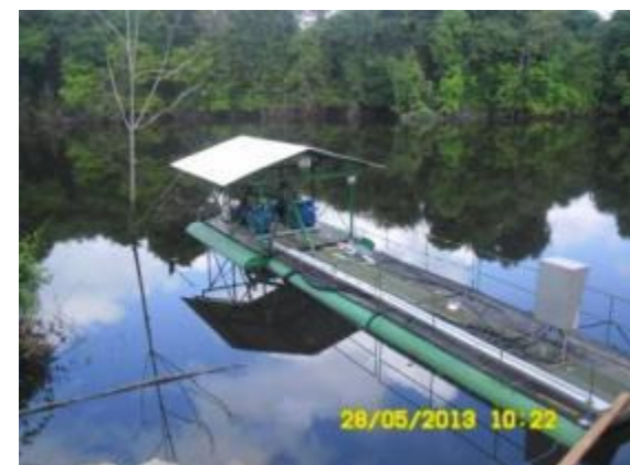
Figura - 22 – Captação de água bruta no Rio Xingu - Pimental
