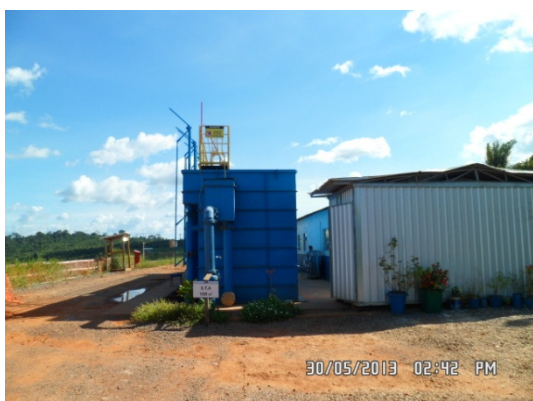
Figura - 5 – ETA 100m 3 /h do Sitio Belo Monte
