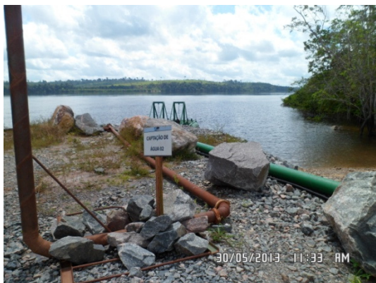
Figura - 3 – Captação de água bruta no Rio Xingu da ETA de 35m 3 /h – Belo Monte
