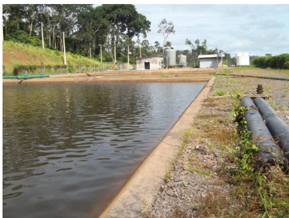
Figura - 9 – Tanque de água industrial Canais
