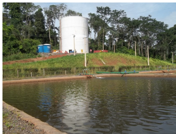
Figura - 10 – Tanque reservatório Canais
