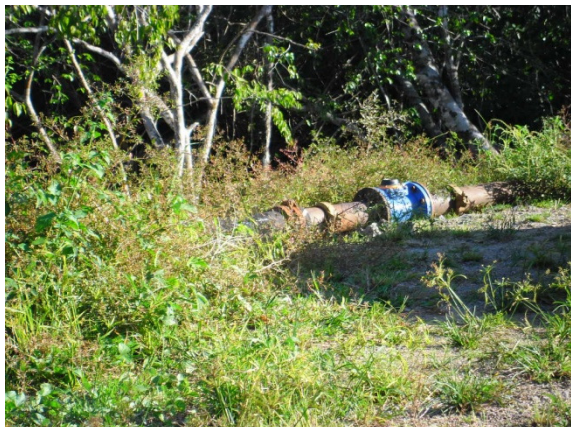
Figura - 13 – Rede adutora Diques
