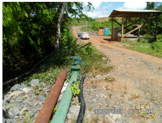
Figura - 2 – Rede de adutora de água da ETA de 100m 3 /h – Belo Monte
