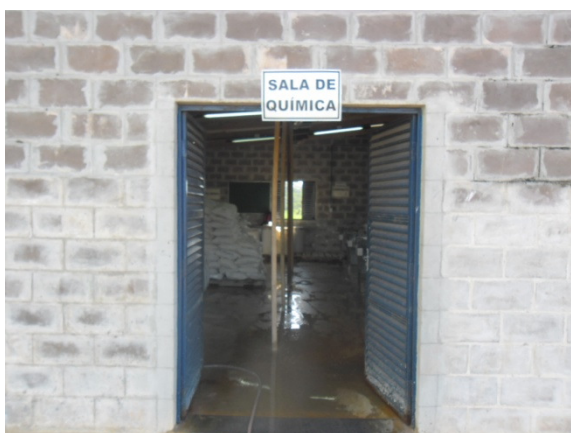
Figura - 17 – Depósito de produtos químicos ETA - Canais
