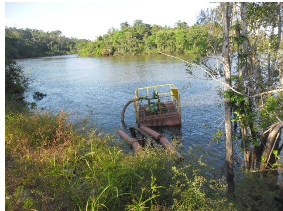
Figura - 14 – Captação água bruta Bela Vista
