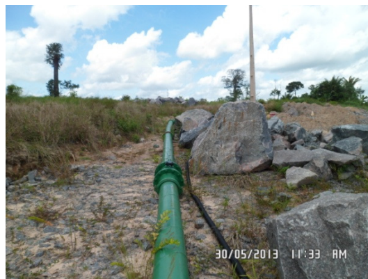
Figura - 4 – Rede de adutora de água da ETA de 35m 3 /h – Belo Monte
