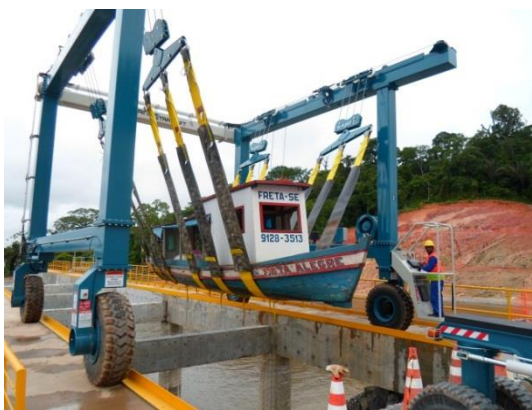
Figura 14.2.2 - 15 – Transposição via STE de barco de madeira com capacidade para 4,0 toneladas, em março/2013
