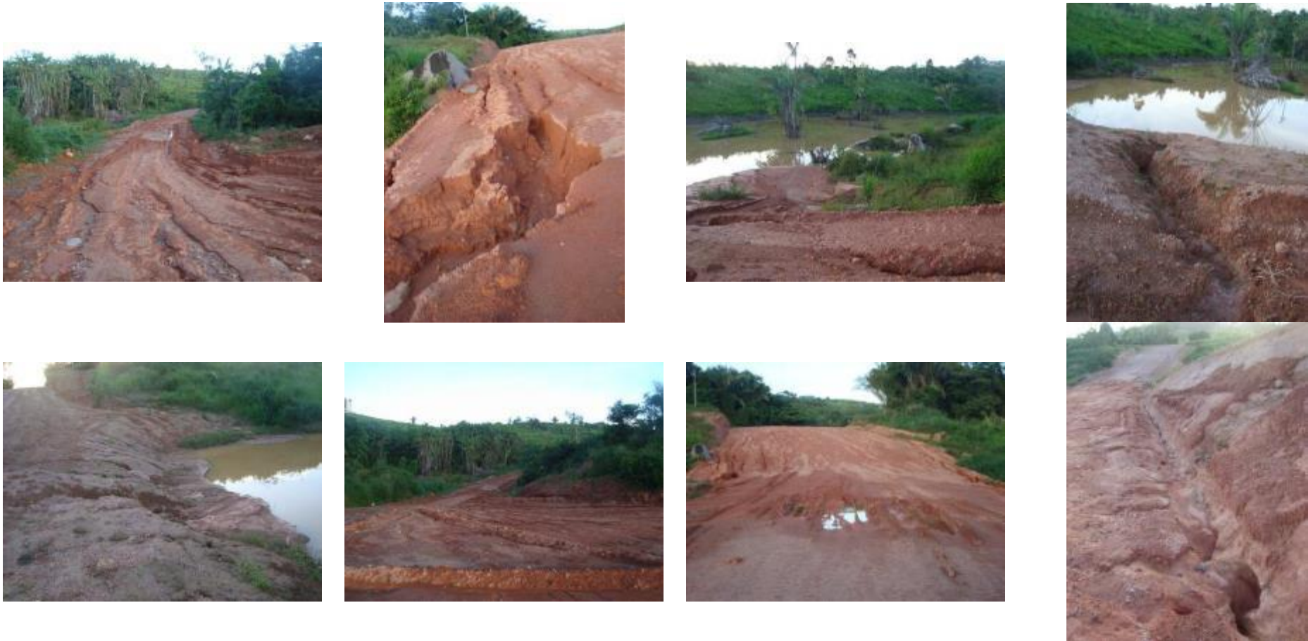
Figura 10.3 - 11 – Ilustrações da região próxima ao Canteiro Bela Vista, com processos erosivos ativos. A região deve ser tratada preventivamente à erosão por efeito de ondas. Coordenadas 416.825 / 9.637.308.
