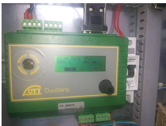
Figura 5: Medição digital do Nível do Igarapé Altamira na Estação.
