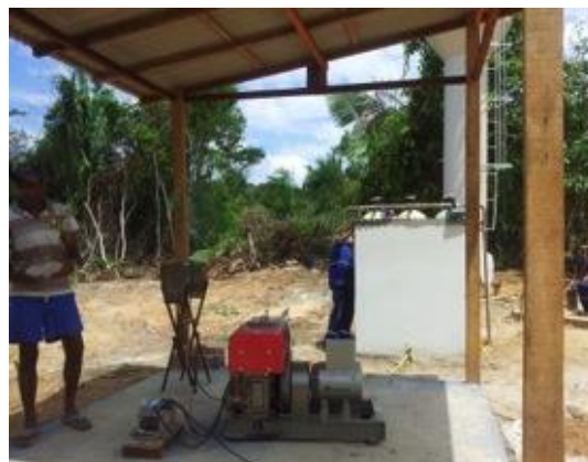
Figura 13.2 - 67 – Poço Ilha da Fazenda
