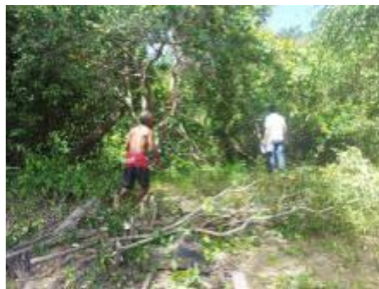
Figura 13.2 – 2 - Vistoria Prop. IL-383
