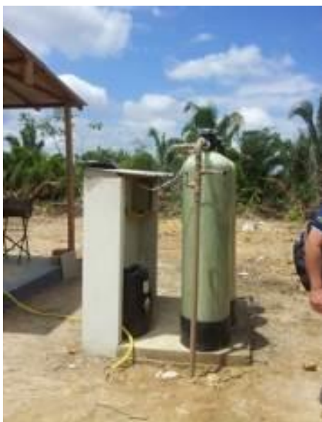
Figura 13.2 - 64 – Poço Ilha da Fazenda.
